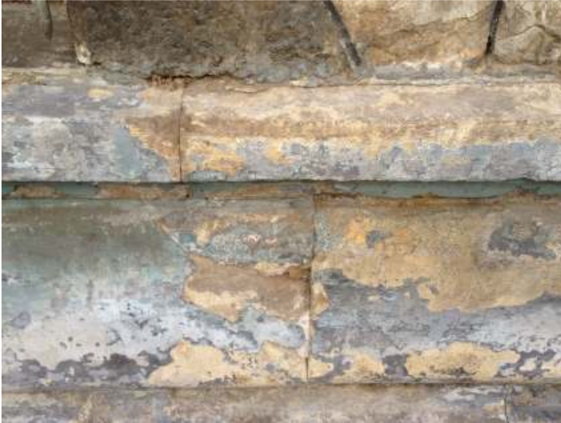
Ρηγμάτωση επιχρίσματος στην κύρια όψη
