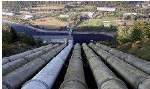
ΦΩΤ.1.6 . : Αριστερά: Ποτάμια μονάδα ηλεκτροπαραγωγής, Δεξιά: Ταμιευτήρας με φράγμα, Κάτω: Αντλητική μονάδα
