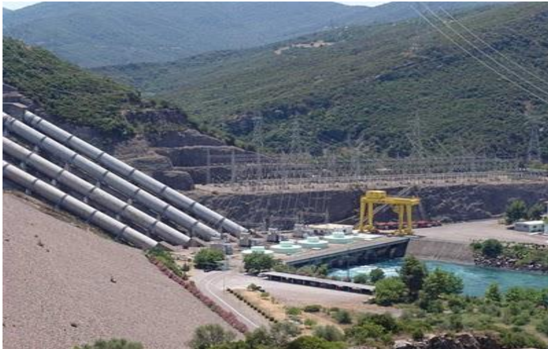
ΦΩΤ.2.3 .: ΥΔΡΟΗΛΕΚΤΡΙΚΟΣ ΣΤΑΘΜΟΣ ΦΡΑΓΜΑΤΟΣ
