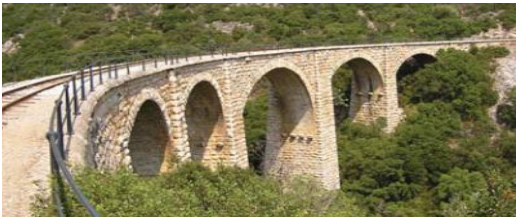
Εικόνα 26. Η μεγαλύτερη σιδηροδρομική γέφυρα του Μουτζούρη με πέντε τόξα μεταξύ Λεχωνίων και Γατζέας. Μέγιστο ύψος μεσαίου τόξου 23 μέτρα
