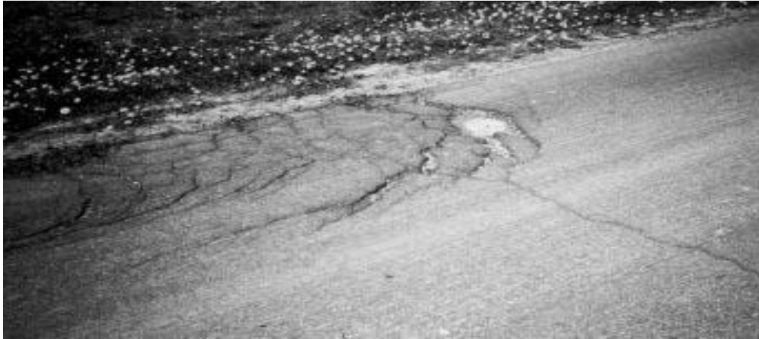
Εικόνα 3.5 Ρωγμές από ολίσθηση ταπήτων
