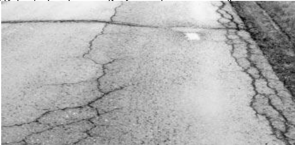
Εικόνα 3.2 Ρηγμάτωση στο άκρο του δρόμου
