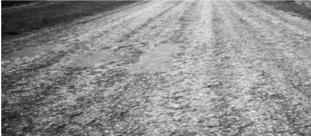
Εικόνα 3.10 Αποκόλληση αδρανών- απώλεια υλικού επιφάνειας
