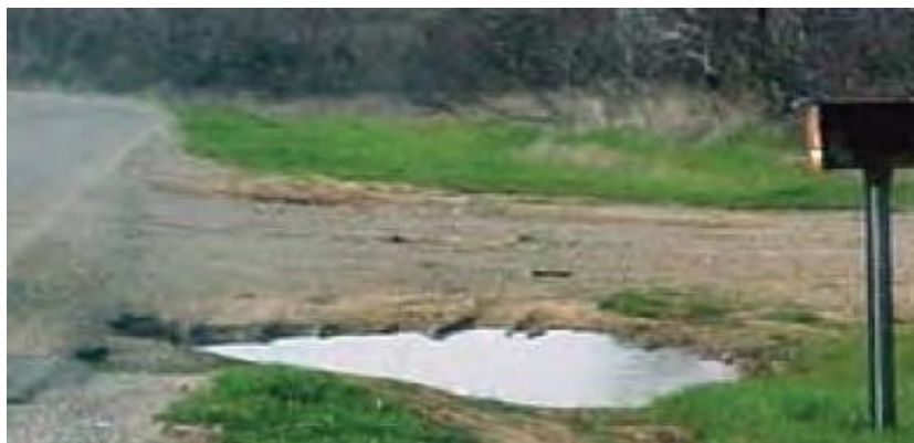
Εικόνα 3.16 Πρόβλημα στην άκρη οδοστρώματος
