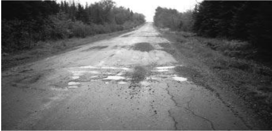
Εικόνα 3.12 Λακκούβες στο οδόστρωμα
