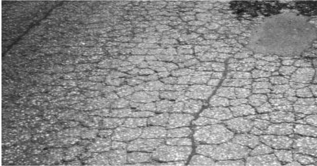
Εικόνα 3.1 Ρωγμές τύπου αλιγάτορα
