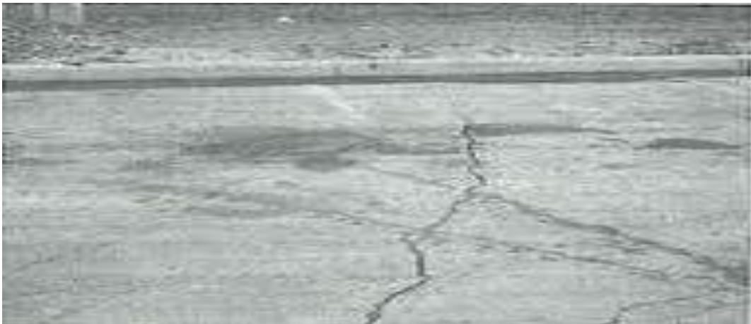
Εικόνα 2.1 Ρωγμές εξαιτίας θερμικής διαστολής
