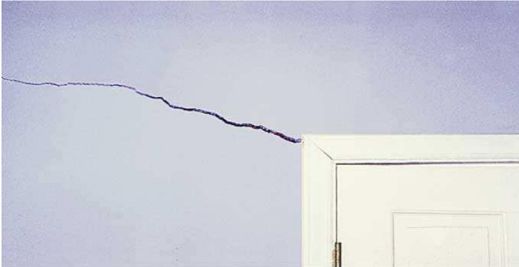
Φωτογραφία 4.6 Διαγώνιες ρωγμές σε εσωτερικό τοίχο
