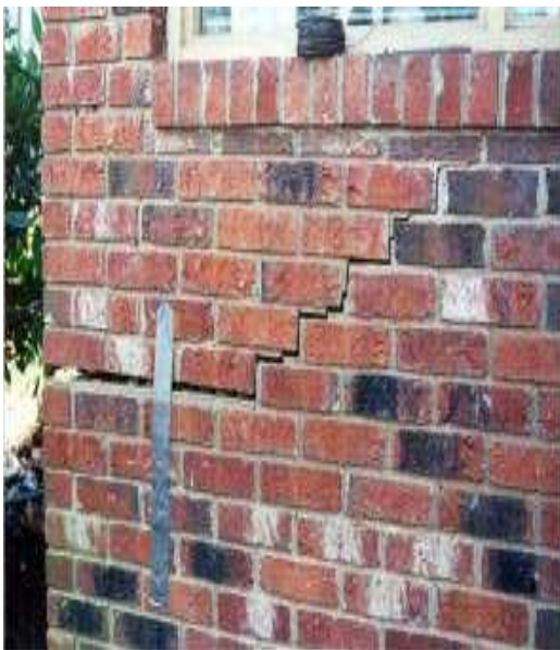
Φωτογραφία 4.1 Οριζόντια διαχωριστική ρωγή σε εξωτερικό τοίχο
