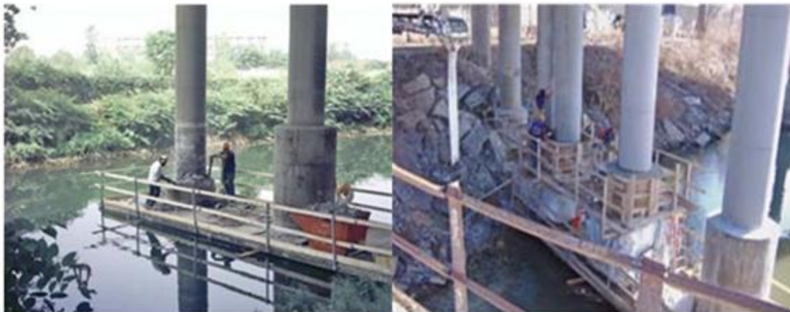
Εικόνα 27. Τμήματα από τις Scajaquada Expressway Bridges που πρέπει να προστατευθούν από το νερό του ποταμού έναντι διάβρωσης
