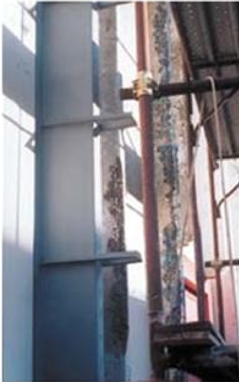
Εικόνα 24. Προκατασκευασμένο τοίχωμα πριν την αποκατάσταση
