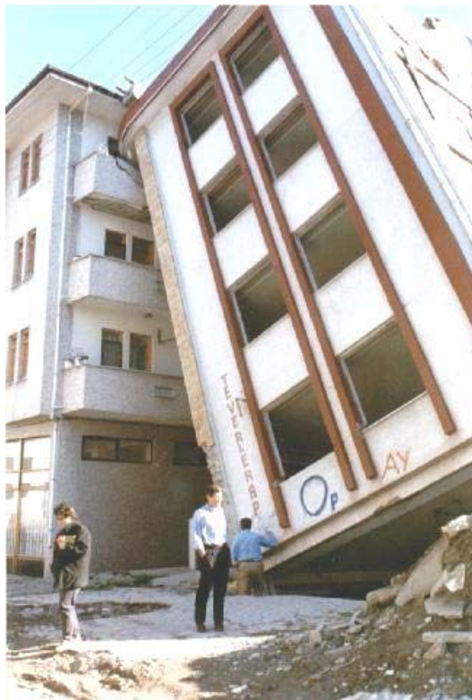
Εικόνα 1.2 Αστοχία θεμελιώσεων κτιρίων λόγω ρευστοποίησης του εδάφους κατά το σεισμό του Izmit, 1999 (Μπουκοβάλας, 2007).
