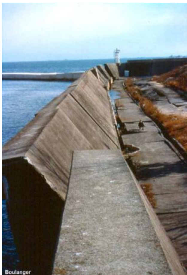
Εικόνα 1.6 Αστοχία λιμενικού κρηπιδότοιχου λόγω ρευστοποίησης του εδάφους κατά το σεισμό του Kobe, 1995 (Μπουκοβάλας, 2007).
