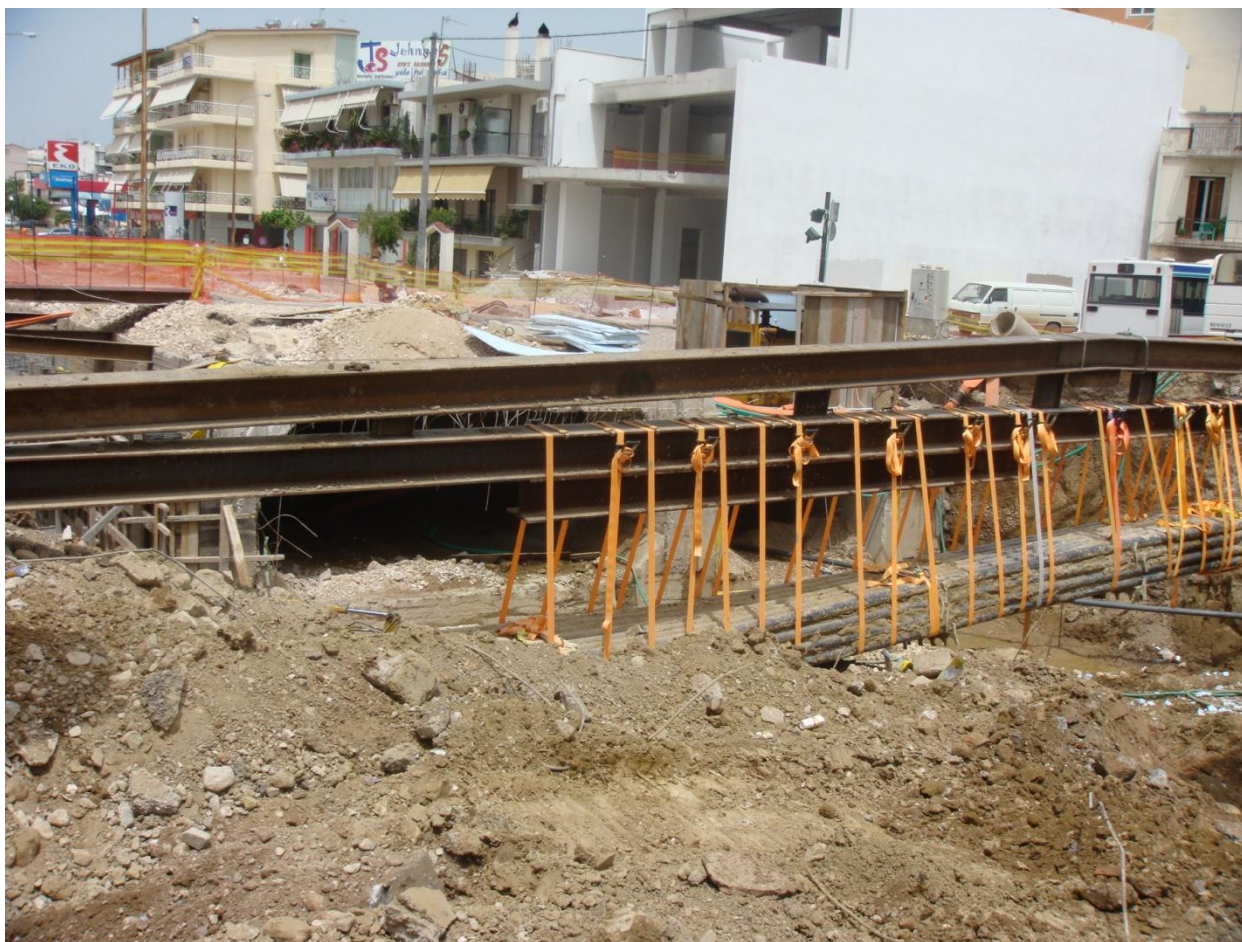
Φωτ. 6 Διασταύρωση οδού Ελ. Βενιζέλου – Αγ. Ιωάννη Πράτσικα ( Χ.Θ. ΕΡΓΟΥ 1+110,00) – Αντιστήριξη πρανών με αντιρίδες
