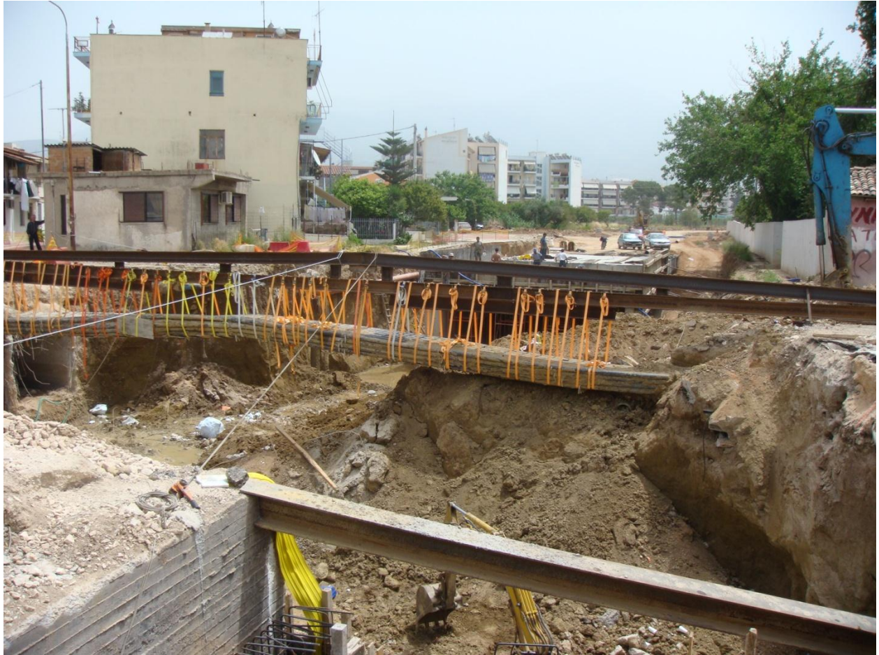
Φωτ.7 Διασταύρωση οδού Ελ. Βενιζέλου – Αγ. Ιωάννη Πράτσικα ( Χ.Θ. ΕΡΓΟΥ 1+110,00) – Αντιστήριξη πρανών με αντιρίδες
