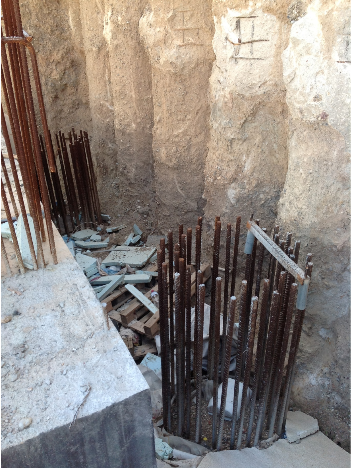
Φωτογραφία 5.8: Οπλισμοί πασσάλων ακρόβαθρου της νέας γέφυρας και αποκαλυμμένοι οπλισμοί ακρόβαθρου της παλαιάς γέφυρας.
