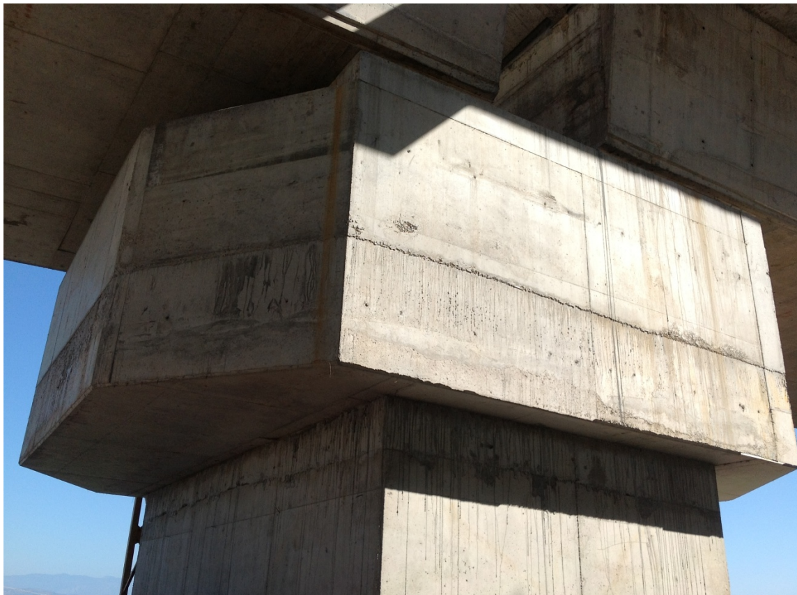
Φωτογραφία 5.10: Αύξηση διατομής του μεσόβαθρου της νέας γέφυρας στη στήριξη στο κατάστρωμα.
