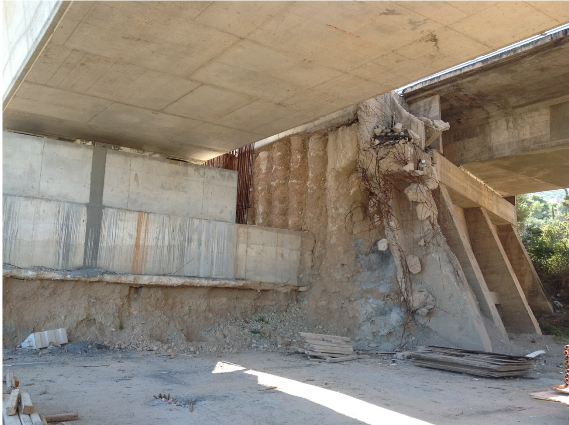
Φωτογραφία 5.6: Ακρόβαθρο της νέας γέφυρας και αποκαλυμμένοι οπλισμοί στο ακρόβαθρο της παλαιάς γέφυρας.
