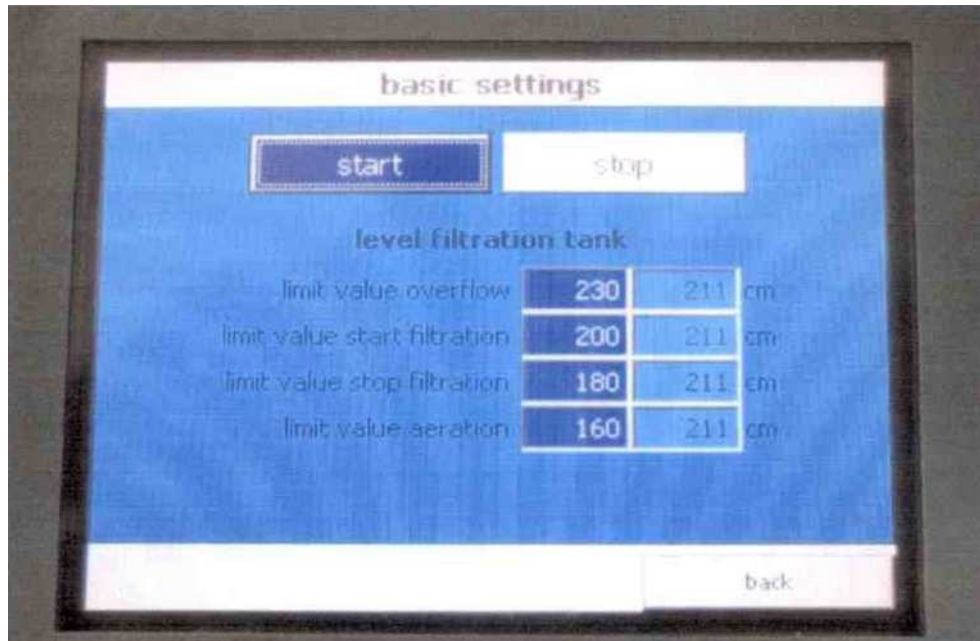
Εικόνα 3.11: Οθόνη ελέγχου δεξαμενής μεμβρανών
