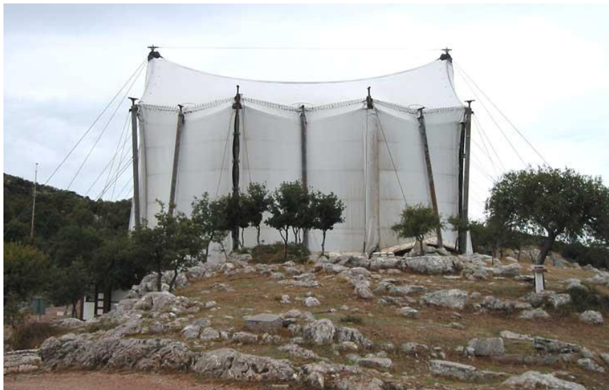
Εικόνα 9. Το στέγαστρο, που προστατεύει το ευαίσθητο οικοδομικό υλικό από τις ακραίες καιρικές συνθήκες της περιοχής, το αντισεισμικό ικρίωμα και οι άλλες εγκαταστάσεις είναι προσωρινά, για όσο διάστημα απαιτήσουν οι σωστικές εργασίες.
