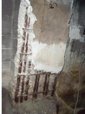
Εικόνα 10. Διάβρωση χαλύβδινου οπλισμού.
