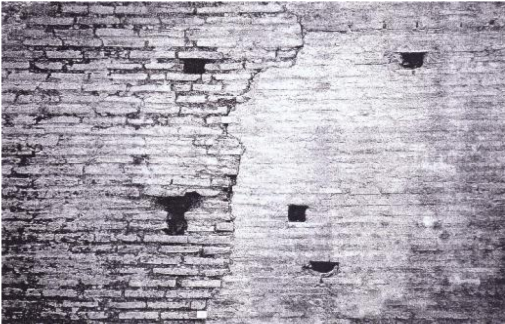
Εικόνα 31. Χαρακτηριστική φθορά και βλάβη (μεγαλο-ρωγμή) της «επιδερμίδας» του τοίχου (ενώ παρατηρείται και πλήθος άλλων μικρο-ρωγμών)
