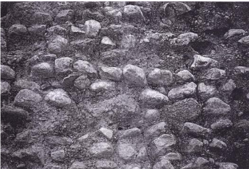
Εικόνα 32. Φθορές και ρωγμές του «πυρήνα» των τοίχων
