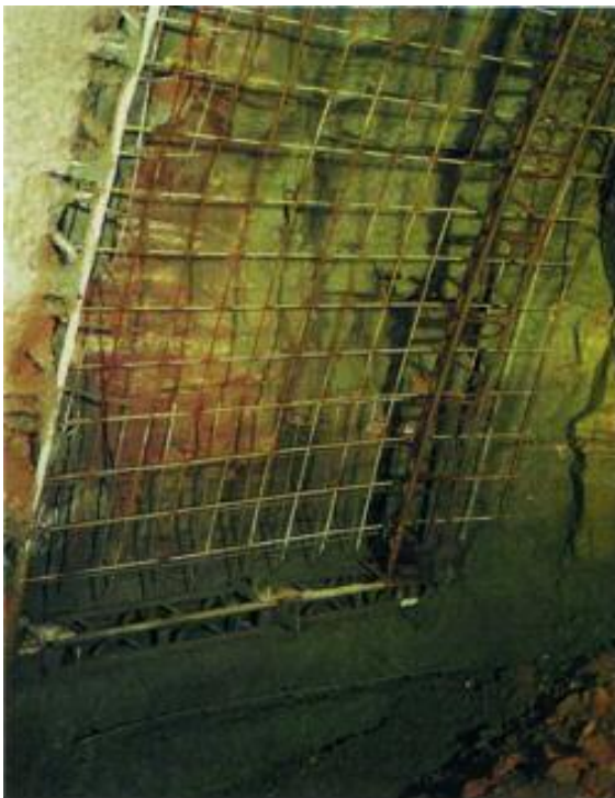
Εικόνα 21. Μετά την εκσκαφή τοποθετείται στρώση εκτοξευόμενου σκυροδέματος για λόγους ασφαλείας και στη συνέχεια αφού τοποθετηθούν χαλύβδινα πλαίσια, τοποθετείται και το μεταλλικό πλέγμα, ώστε μετά να είναι εύκολη η τοποθέτηση της οριστικής στρώσης του εκτοξευόμενου σκυροδέματος.
