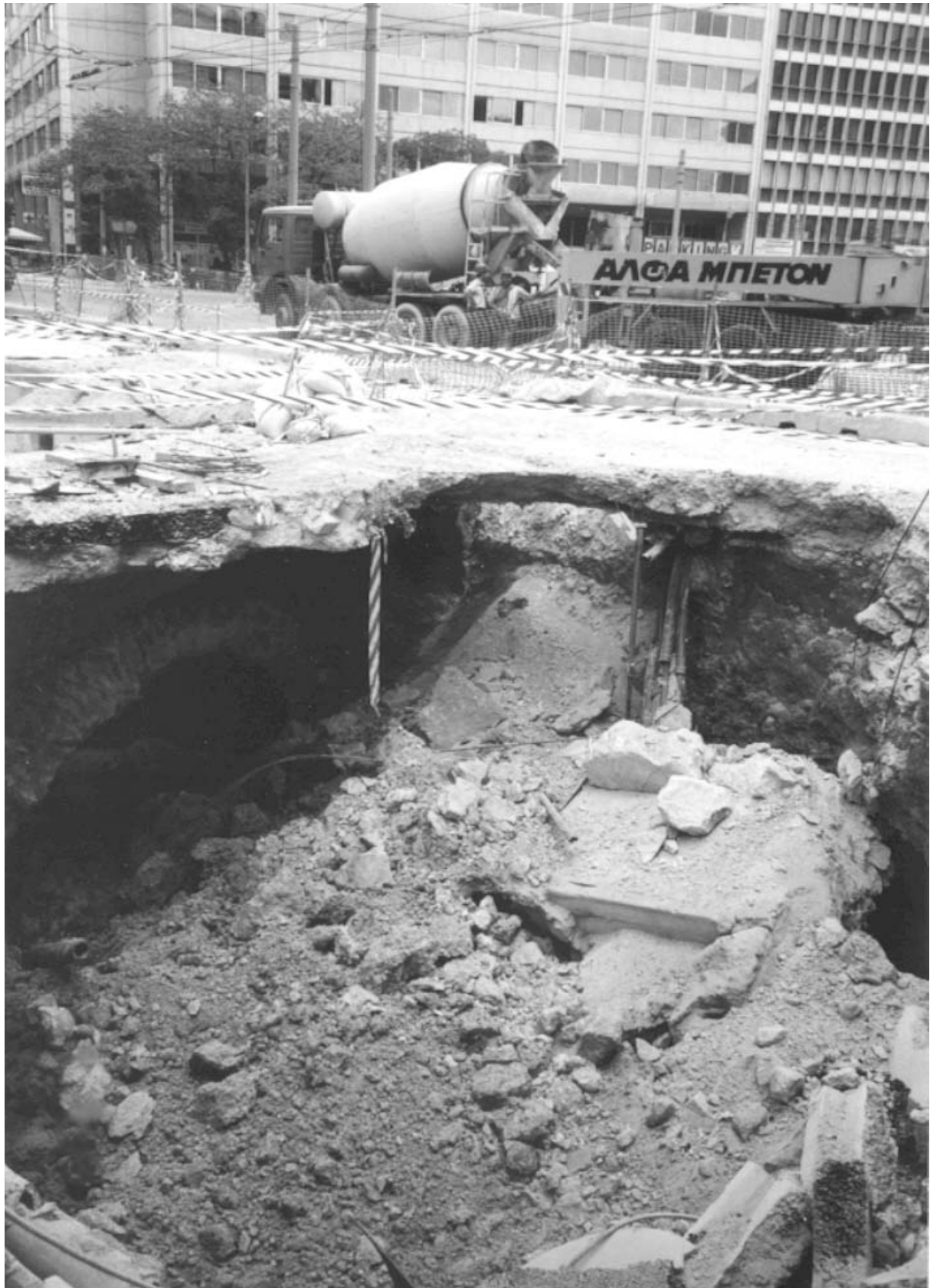
Αστοχία υπό κατασκευή σήραγγας Μέτρο στην Πλατεία Καραϊσκάκη
