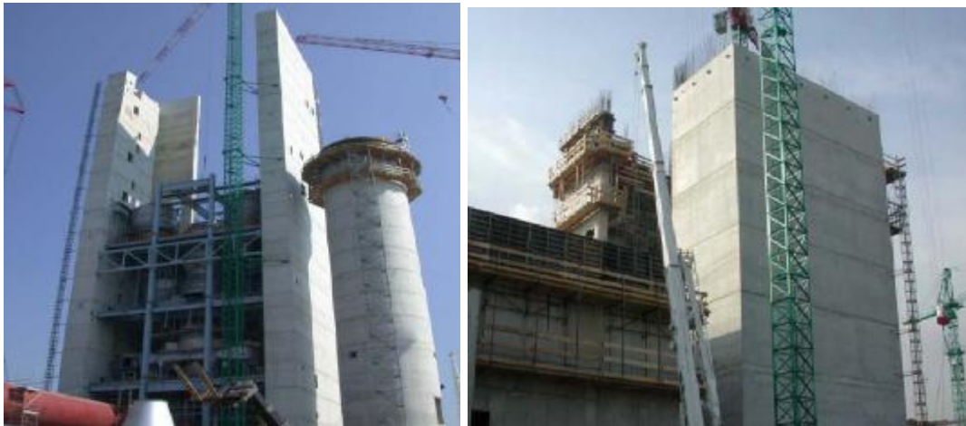
Φωτογραφία 11.7. Νέο εργοστάσιο Italcementi - Calusco, Italy
