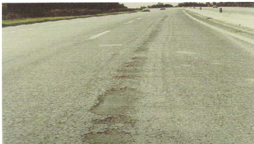
Εικ.4: Αποσύνθεση επιφάνειας οδοστρώματος
