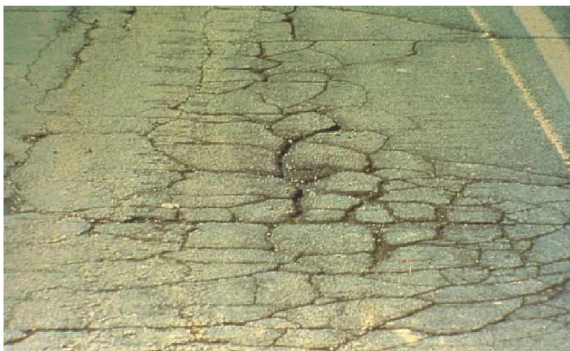
Εικ. 2: Ρωγμές μορφής αλιγάτορα
