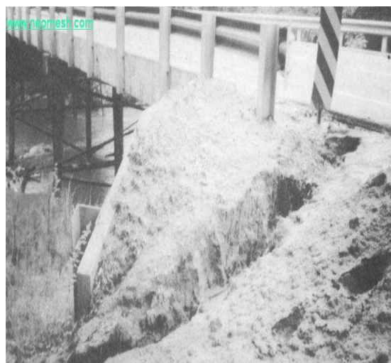
Διάβρωση επιχώματος περυγοτόιχου
