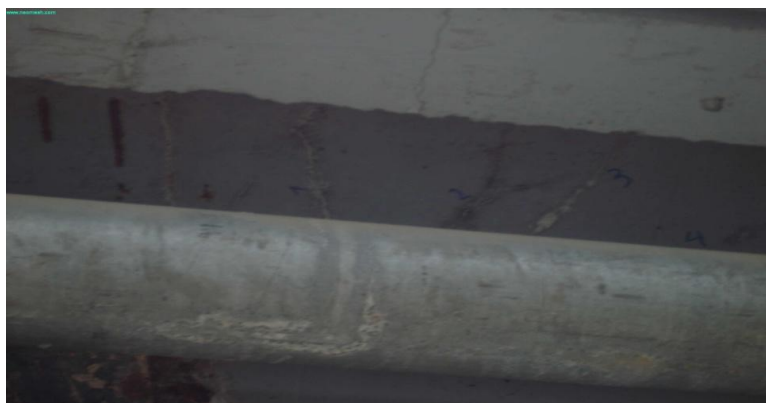
Ρωγμές στην θέση στήριξης
