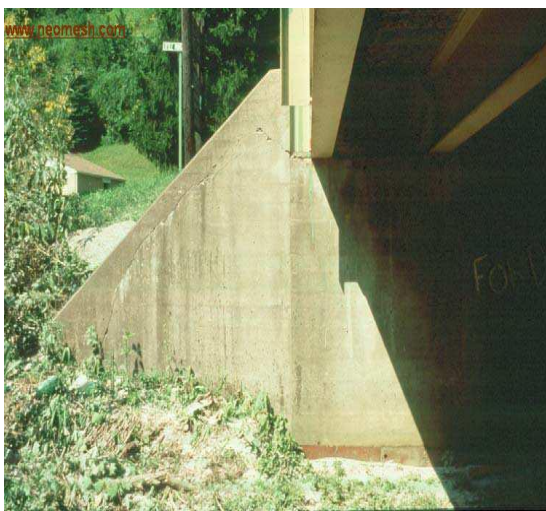
Ρωγμές στον περυγοτόιχο
