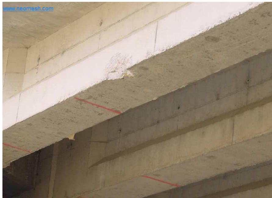
Φθορά από πρόσκρουση ψηλού οχήματος στο πέλμα της πλακοδοκού
