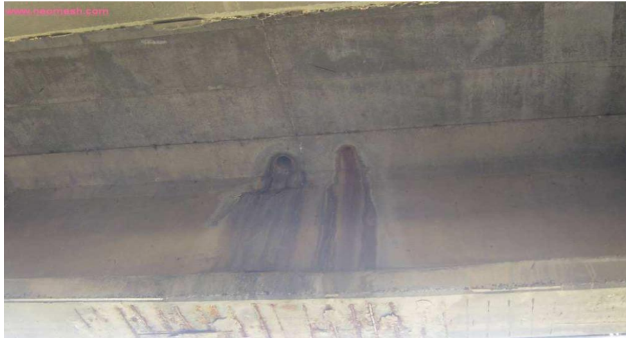
Πλακοδοκός εκτεθειμένη σε ροή ομβρίων υδάτων – Ανεπαρκής αποστράγγιση - αποχέτευση
