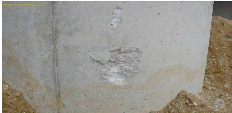
Αποφλοιώση τσιμέντου στο μεσόβαθρο
