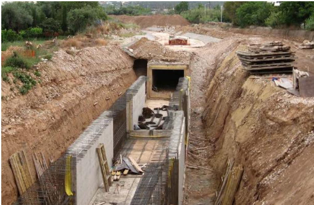
Σχήμα 1.1 Απλή εφαρμογή της μεθόδου cut & cover – Εγκιβωτισμός της κοίτης του χειμάρρου Διακονιάρη στην Πάτρα
