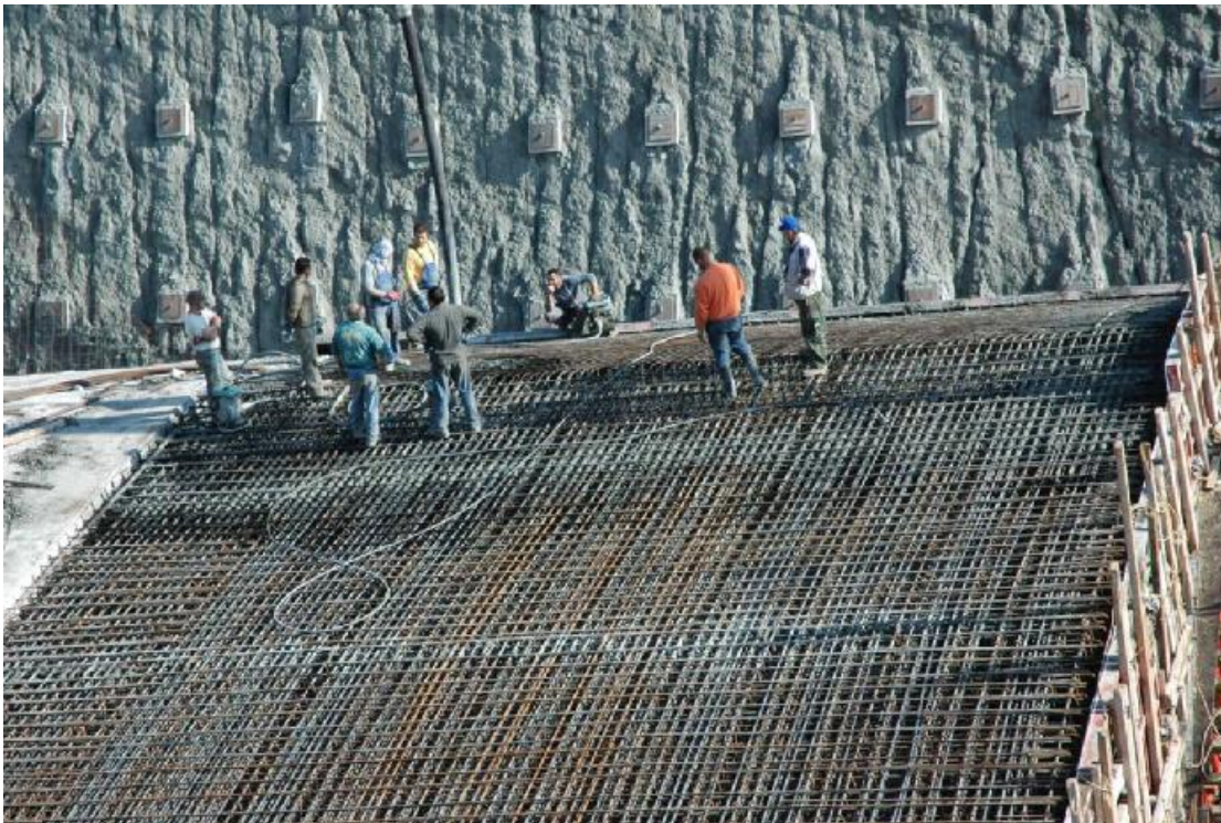
Σχήμα 4.6 Παράλληλες εργασίες σε τρία φατνώματα α) σιδέρωμα , β) σκυροδέτηση και γ) τοποθέτηση γεωφάσματος και στεγανωτικής μεμβράνης
