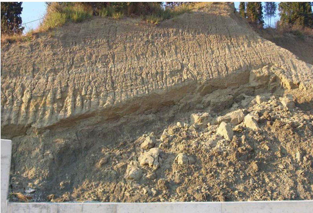
Σχήμα 3.23 Αποκολλήσεις και πτώσεις τεμαχών στο επίπεδο της στρώσης στο σώμα των Ανώτερων μαργών. Διακρίνονται οι σχηματισμοί αυλακώσεων. Αριστερό πρανάς Χ.Θ. 0+850+900 Μ.Π.Π.
