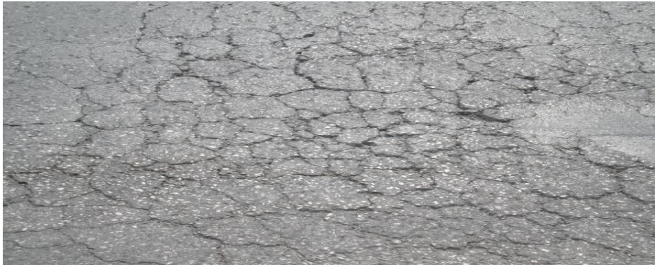
Σχήμα 2.8. : Ρωγμές τύπου αλιγάτορα.
