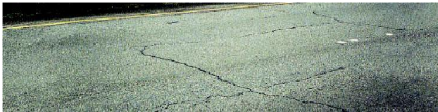
Σχήμα 2.14. : Ρωγμές στο οδόστρωμα κατά τεμάχη (OEMK – Β.9 , 2002).
