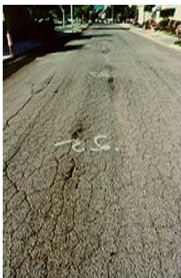
Σχήμα 4.15. : Οδόστρωμα το οποίο χρειάζεται την εφαρμογή της μεθόδου Hot Asphalt Rubber Seal. Διακρίνονται οι ρωγμές αλιγάτορα ( www.slurry.com ).
