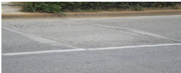
Σχήμα 2.3. : Τοπικές καθιζήσεις σε τομές οδοστρώματος.
