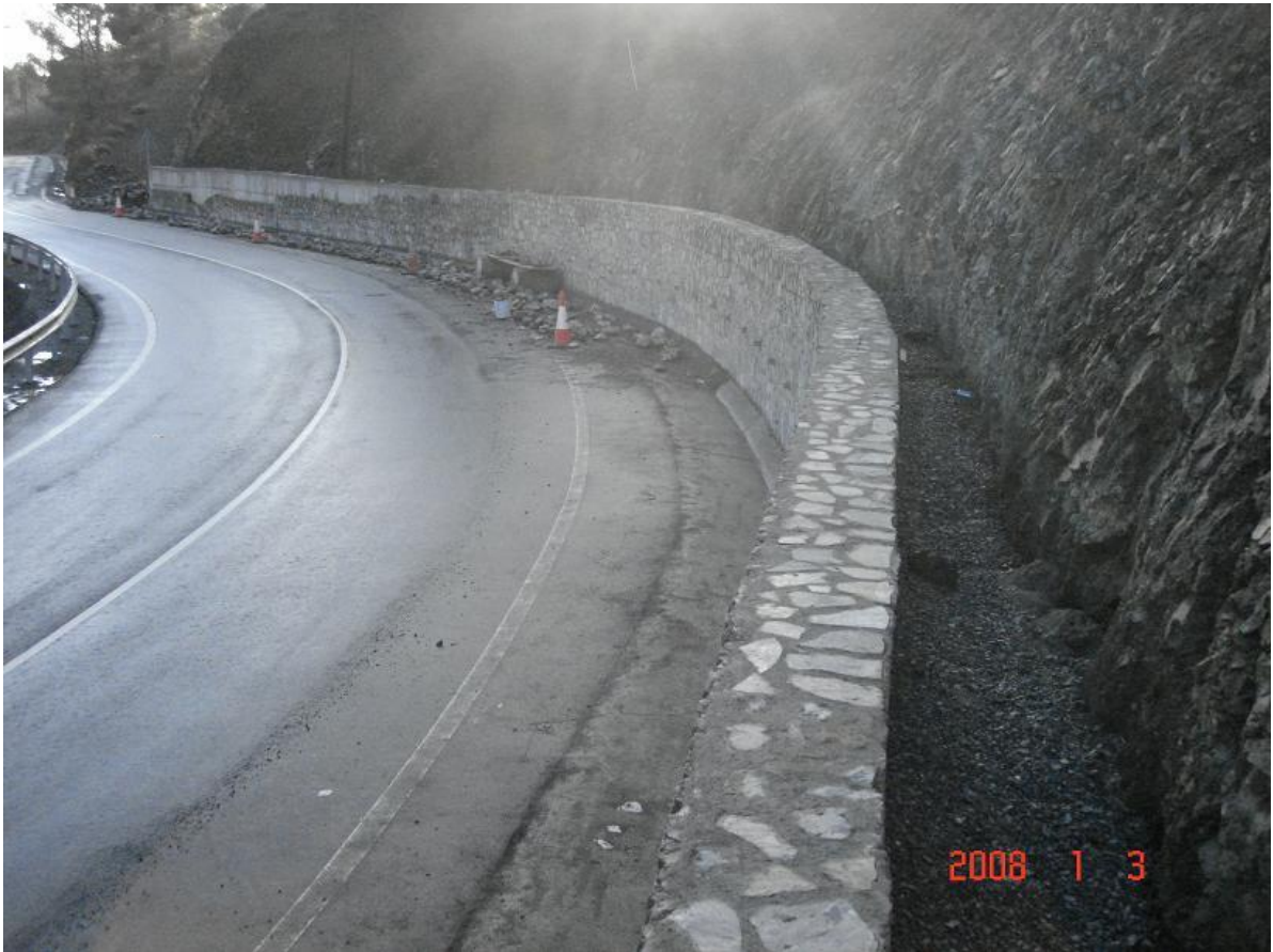
Φωτ. 7.12 Τοίχος αντιστήριξης πρανούς για την εμπόδιση κατολισθήσεων.
