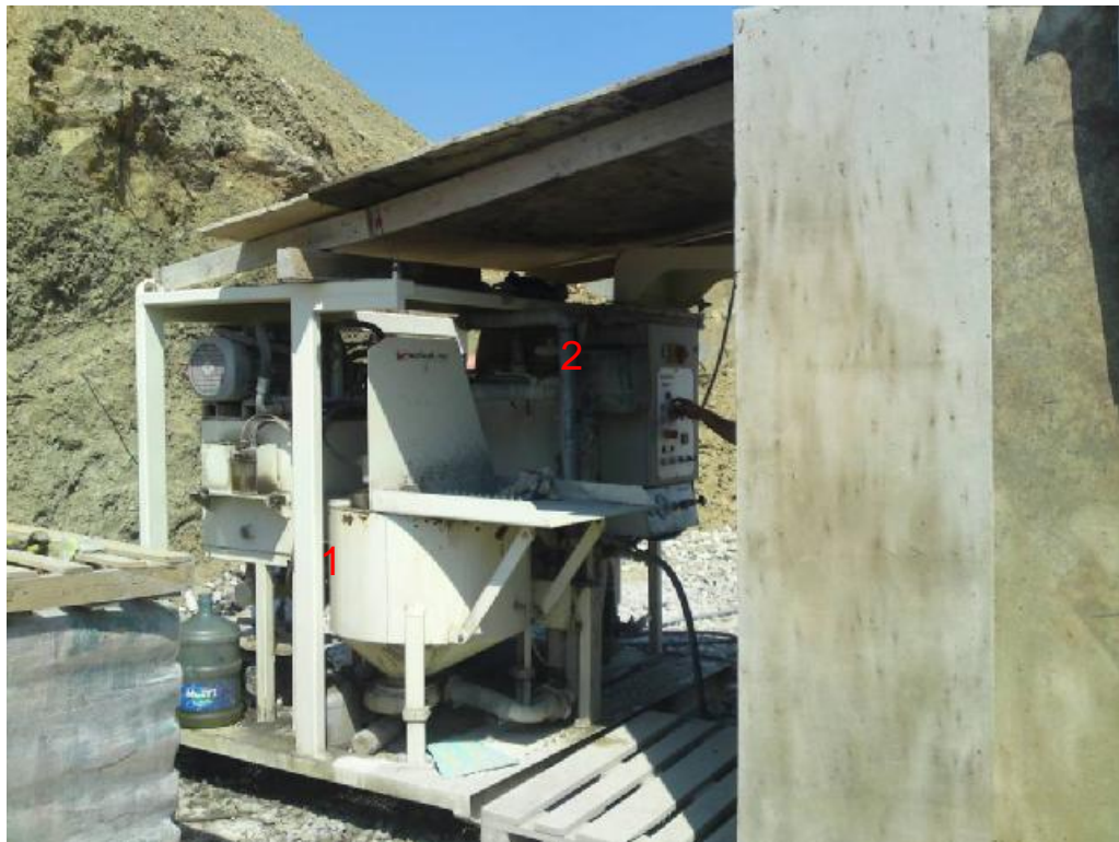
Σχήμα 5.18 Εγκατάσταση ανάμειξης (1) Δοχείο ανάμειξης, (2) Πίνακας Ελέγχου
