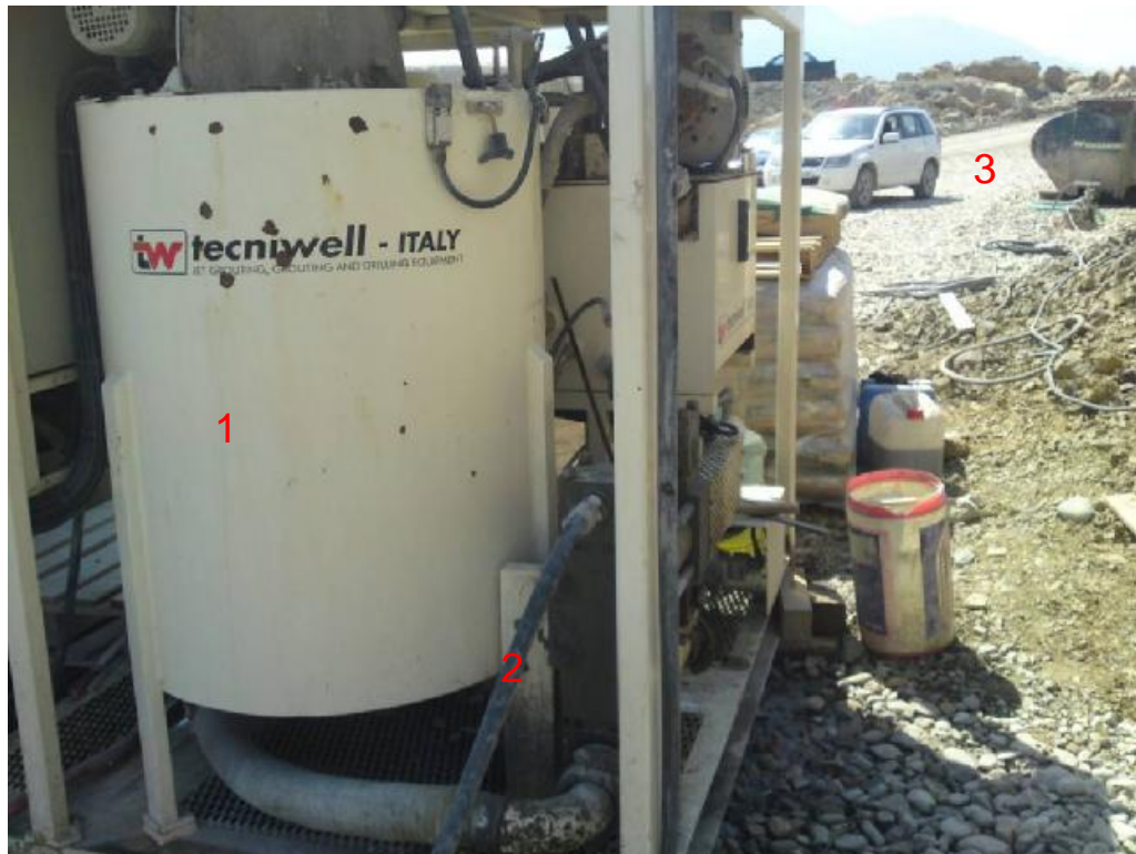
Σχήμα 5.19 Εγκατάσταση ανάμιξης: (1) Δεξαμενή ανάδευσης, (2) Αντλία προώθησης ενέματος, (3) Δεξαμενή νερού
