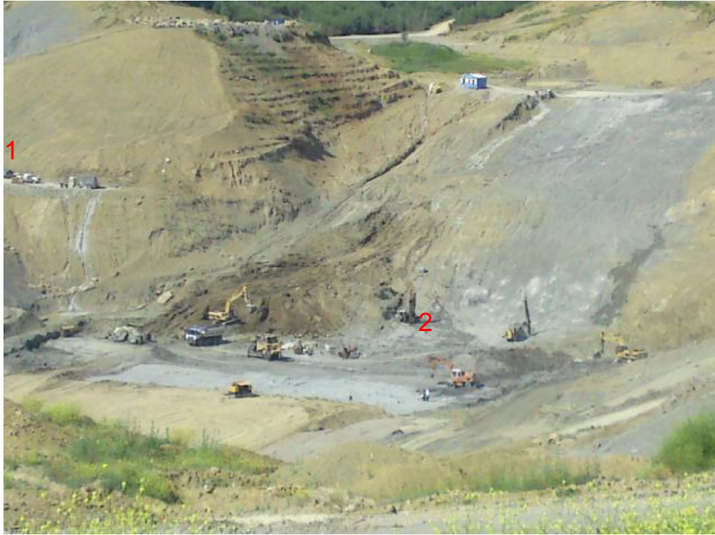
Σχήμα 5.17 Πανοραμική λήψη των εργασιών εκτέλεσης των τσιμεντενέσεων: (1) Εγκαταστάσεις ανάμιξης-ανάδευσης και (2) διάνοιξη οπών τσιμεντενέσεων
