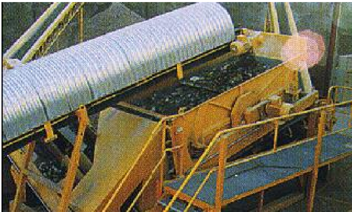
Εικόνα 5.5.Κέντρο διαχωρισμού και κοσκινίσματος
