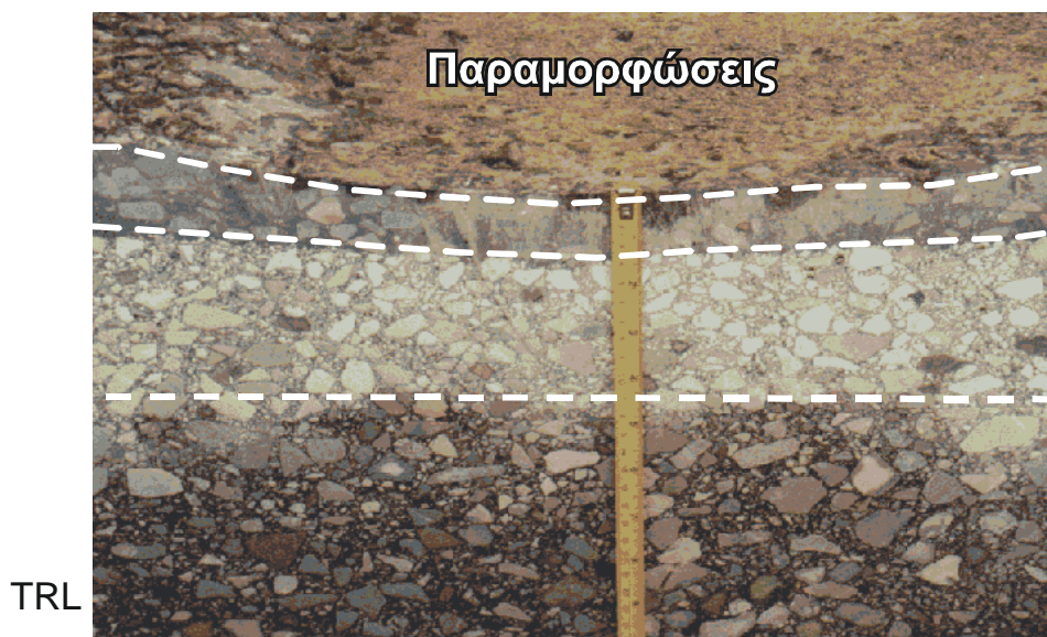
Σχήμα 19. Τομή οδοστρώματος - παραμορφώσεις
