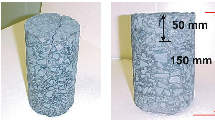
Σχήμα 21. Δείγματα από ρηγματωμένο οδόστρωμα. Φαίνεται καθαρά ότι οι φθορές έχουν σταματήσει σε βάθος 50 χιλιοστών από την επιφάνεια
