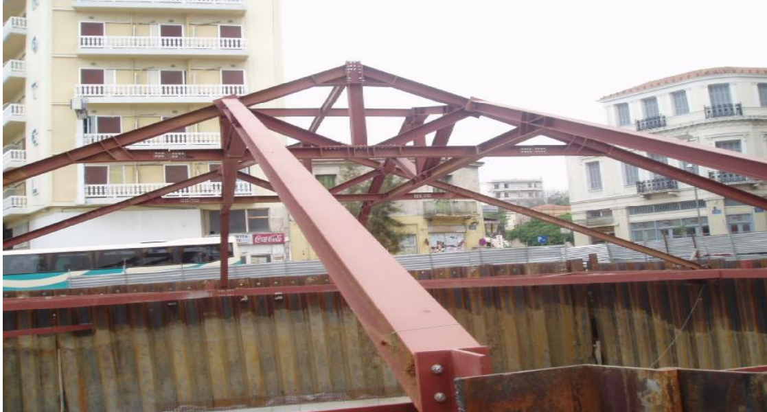
Σχ.4-10 Μεταλλικός σκελετός
