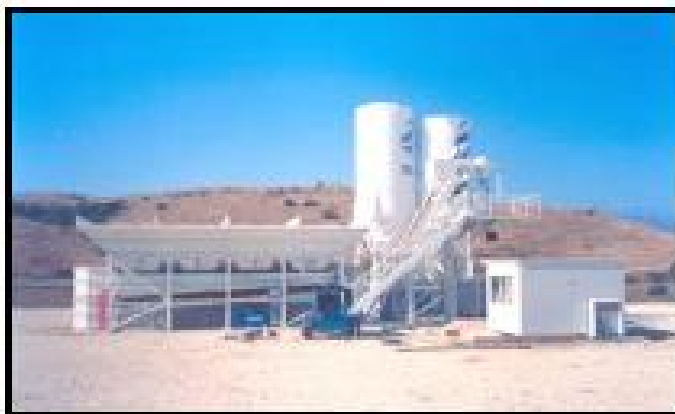
Κινητό συγκρότημα παραγωγής σκυροδέματος σε ευθεία διάταξη
