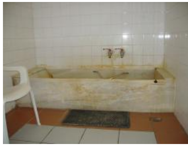
Εικόνα 16. Μία μπανιέρα στις σύγχρονες εγκαταστάσεις
