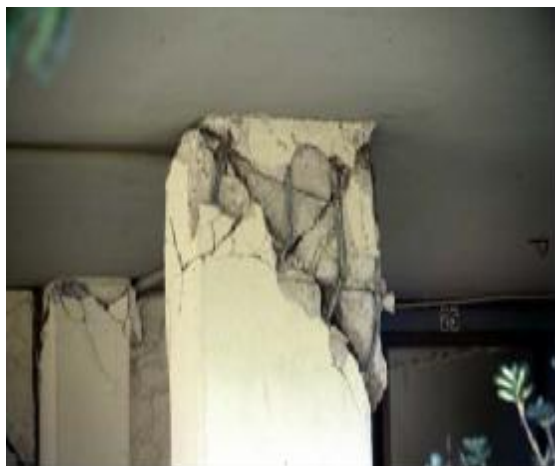
Διατμητικές αστοχίες υποστυλωμάτων, οφειλόμενες σε χρήση συνδετήρων μικρής διαμέτρου σε μεγάλες αποστάσεις. (λυγισμός ράβδων και θραύση λεπτών & αραιών συνδετήρων)
