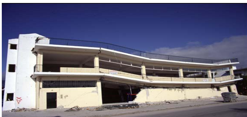
Αστοχία σειράς κοντών υποστυλωμάτων
