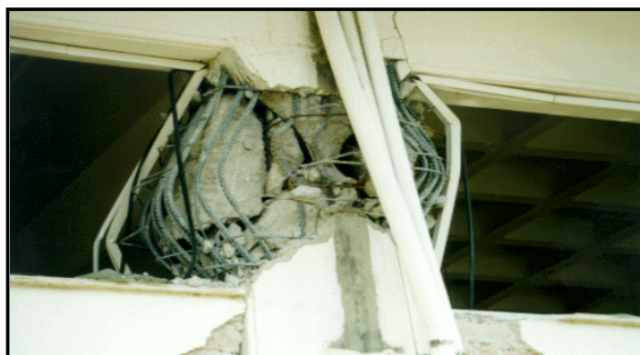
Αστοχία κολώνας 5όροφης οικοδομής στην περιοχή των Άνω Λιοσίων (έτος κατασκευής 1997) που προκλήθηκε από το σεισμό της 7ης Σεπτεμβρίου 1999 (M=5.9) (Anastasiadis et al., 1999).
