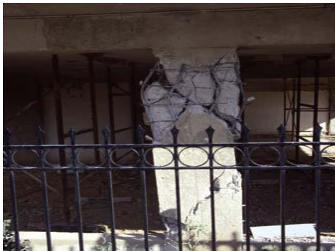
Διατμητική αστοχία υποστυλώματος πάνω & κάτω με λυγισμό ράβδων και θραύση λεπτών & αραιών συνδετήρων
