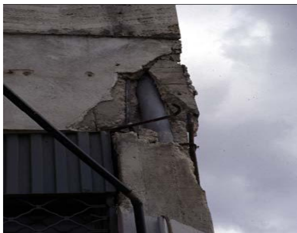
Αστοχία κόμβου και απώλεια περίσφιγξης συνδετήρων λόγω τοποθέτησης υδρορροής εντός του υποστυλώματος
