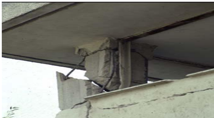
Αστοχία κοντού υποστυλώματος
