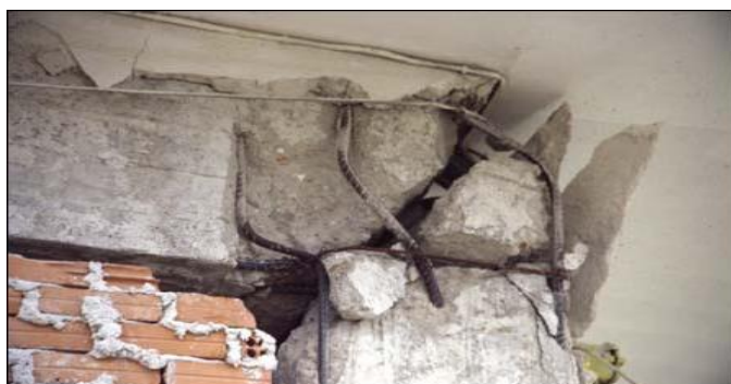
Αστοχία εξωτερικού κόμβου και πρακτική απώλεια στήριξης δοκού
