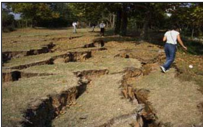
Εδαφικές ρωγμές που παρατηρήθηκαν αμέσως μετά το σεισμό της 17ης Αυγούστου 1999 ( M=7.5 ) στην περιοχή της Νικομήδειας (Izmit) της Τουρκίας (USGS).
