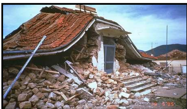
Κατάρρευση σπιτιού σε χωριό της περιοχής Κοζάνης-Γρεβενών από το σεισμό της 15ης Μαΐου 1995 (M=6.6)
