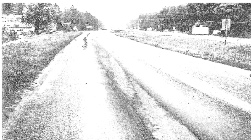
Σχήμα 3.35.: Αυλάκωση σε μία οδό μεγάλης κυκλοφορίας. Σημειώνεται το νερό στις αυλακώσεις της αριστερής λωρίδας. Οι συνθήκες αυτές είναι επικίνδυνες, γιατί προκαλούν ολίσθηση.
