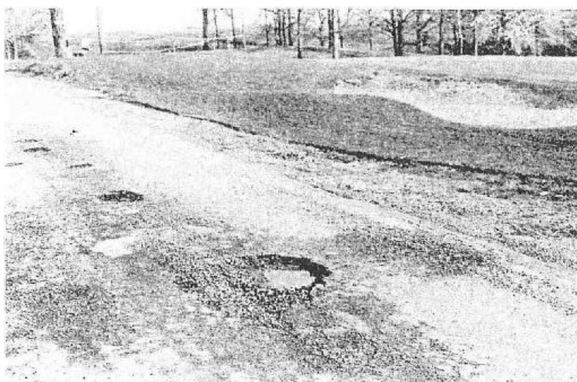
Σχήμα 3.34.: Αποτυχία χαλικώδους βάσης. Σημειώνεται ρηγμάτωση μορφής χάρτη κοντά στις οπές, που σημαίνει μετατόπιση της βάσης ή του υπεδάφους.
