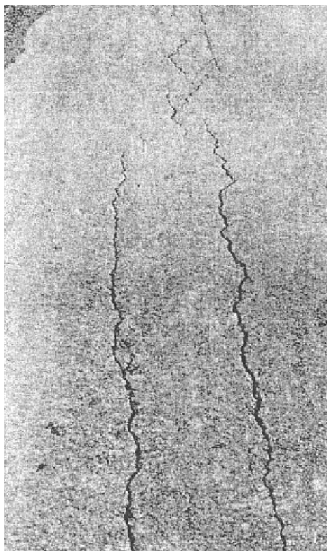
Σχήμα 3.37.: Διαμήκειες ρωγμές σε ένα εύκαμπτο οδόστρωμα.
