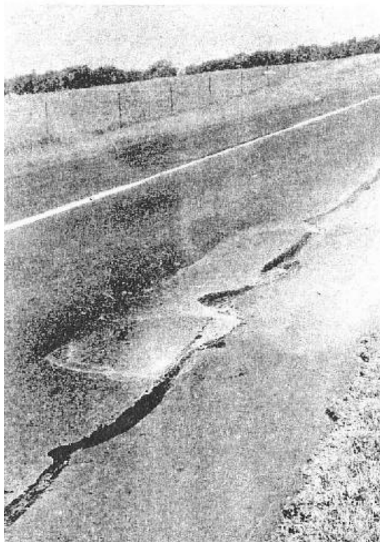
Σχήμα 3.42.: Ανακλαστική ρωγμή σε ασφαλική επανεπίστρωση και διαπλάτυνση οδοστρώματος. Αυτό το δύσκαμπτο οδόστρωμα δείχνει ύπαρξη ανάβλυσης.
