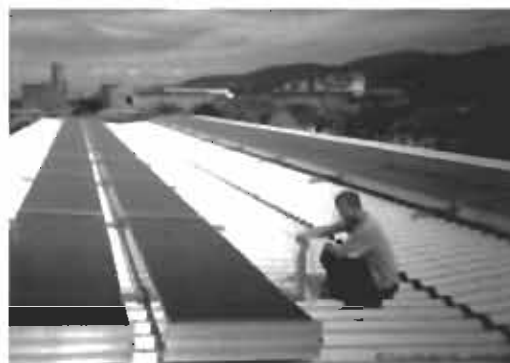
Σύστημα ηλιακών συλλεκτών για κλιματισμό σε εργοστάσιο στο Φρέϊμπουργκ της Γερμανίας.
