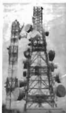
Στην τηλεπικοινωνία ο κλιματισμός είναι αναγκαίος για την λειτουργία των συστημάτων υψηλής τεχνολογίας που την αποτελούν ώστε να μην καταστρέφονται από μεγάλη θερμοκρασία ή υγρασία
