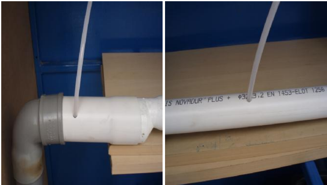
Εικόνα 47: Οπές για σωληνάκια κενομέτρων
