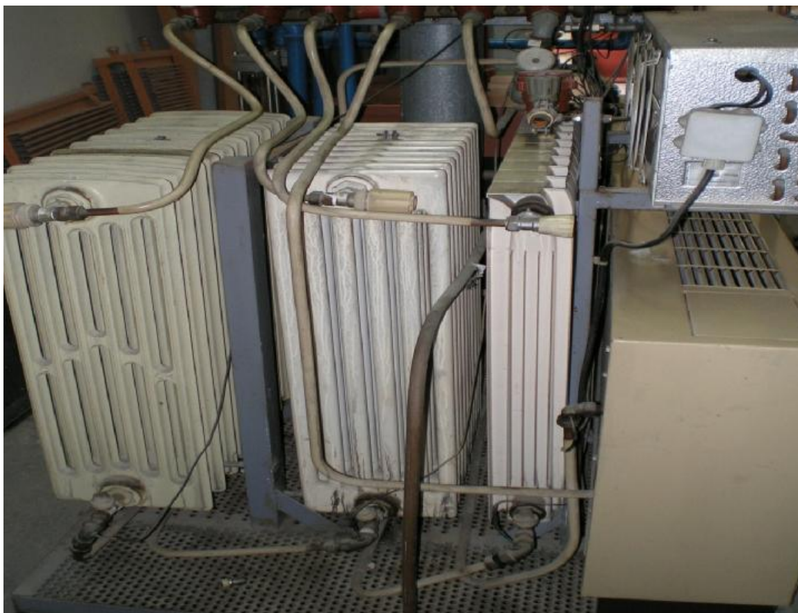
Εικόνα6: θερμαντικά σώματα χυτοσιδήρου, χάλυβα, αλουμινίου και αεραγωγού.
