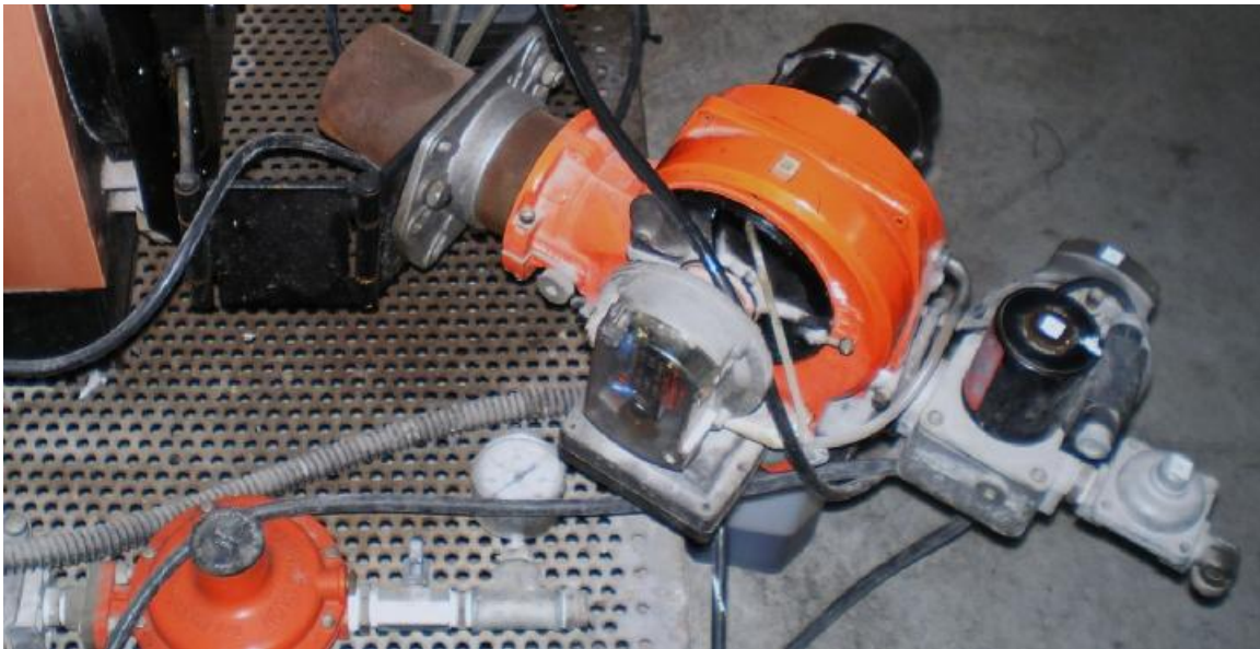
Εικόνα 4: καυστήρας φυσικού αερίου MAXI-6
