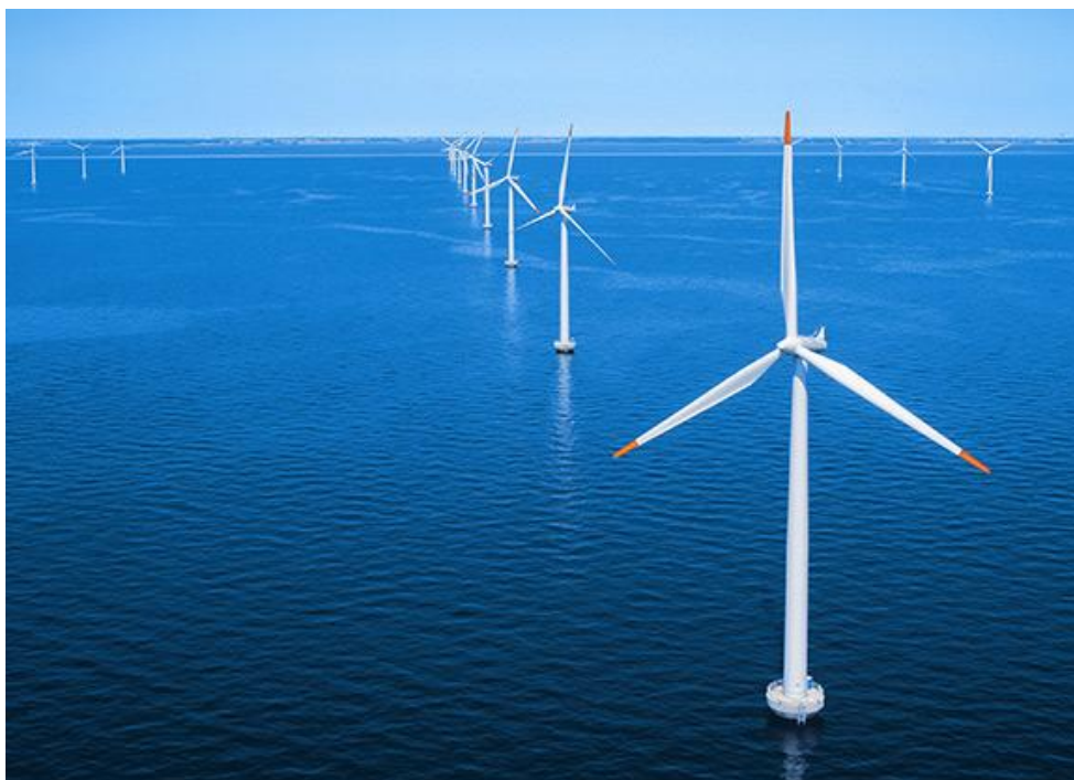
Σχήμα 2-16: Παράκτιο Αιολικό Πάρκο (offshore).
