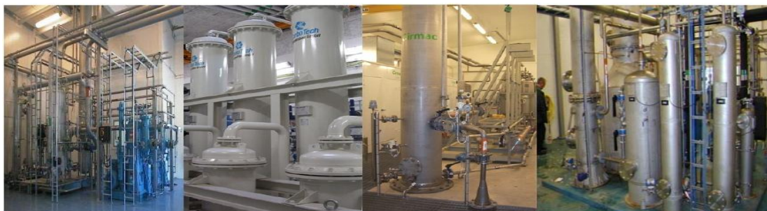
Εικόνα 7.4 Μονάδες αναβάθμισης βιοαερίου στη Σουηδία
