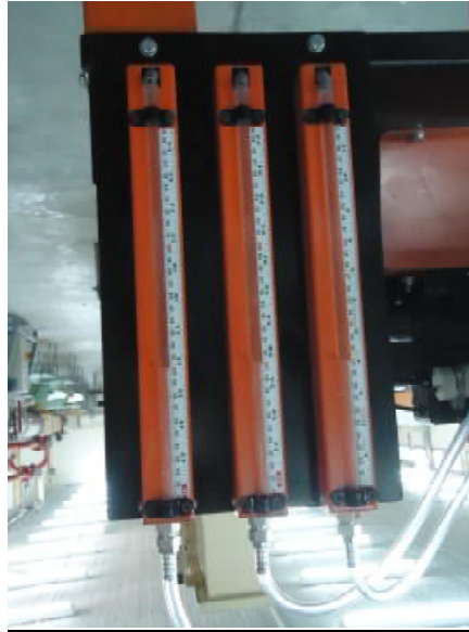
Εικόνα 2.12: Πίνακας μανομέτρων κατασκευής
