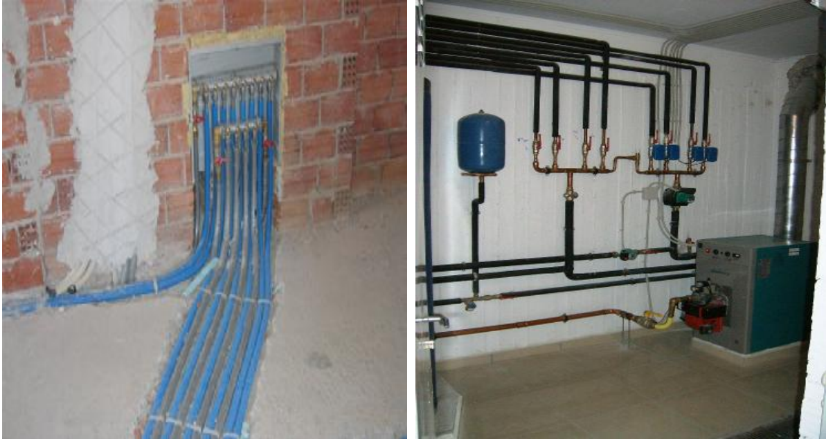
Εικόνα 9: Πλαστικές και χάλκινες σωληνώσεις
