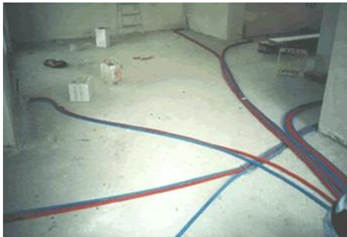
Εικόνα 12: Σωληνώσεις θερμαντικών σωμάτων.
