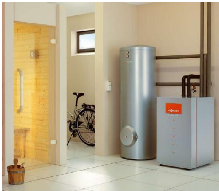
Σχ 2.5 : Λεβητοστάσιο γεωθερμίας
