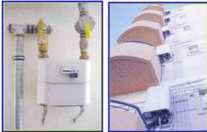
Εικόνα 2.3: Μετρητές φυσικού αερίου
