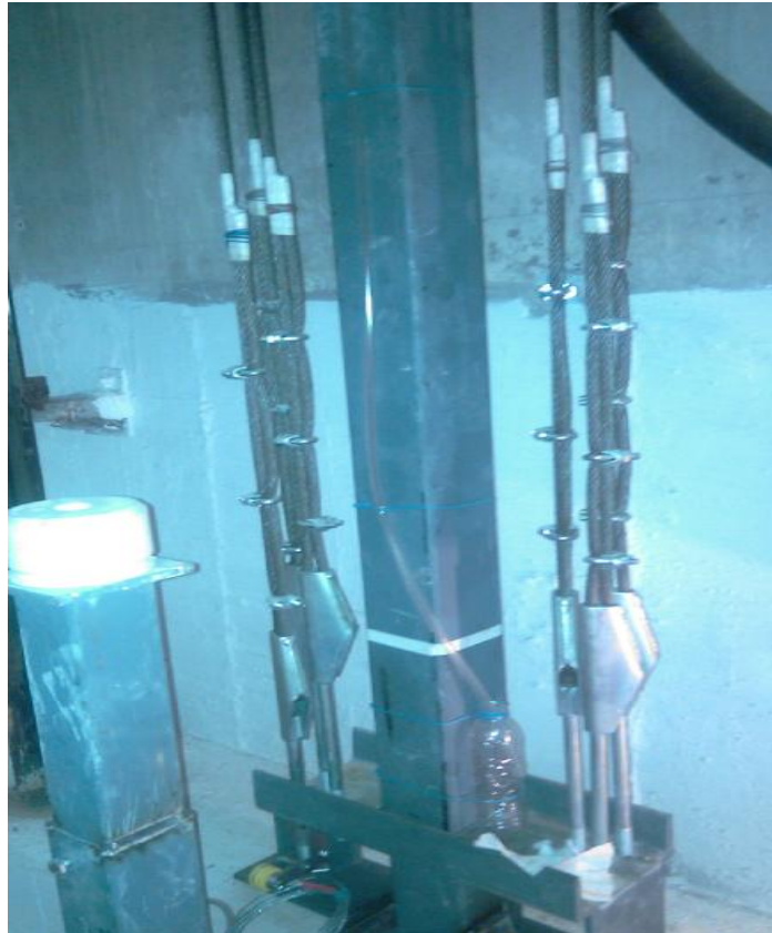
Εικόνα 4.1.: Επικάθηση και κοιλοδοκός στήριξης εμβόλου κυλίνδρου και βάση στήριξης συρματόσχοινων υδραυλικού ανελκυστήρα.
