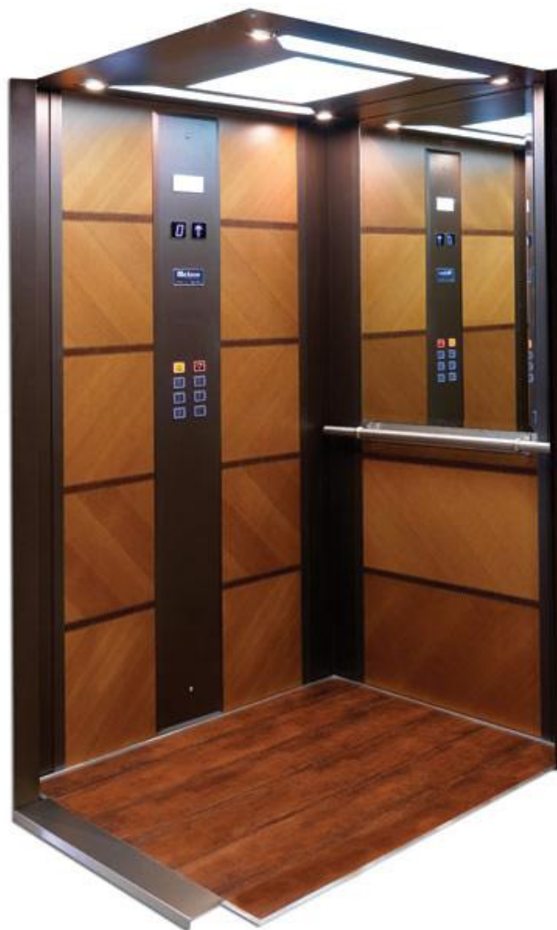
Εικόνα 1.5.: Εσωτερική άποψη υδραυλικού ανελκυστήρα.
