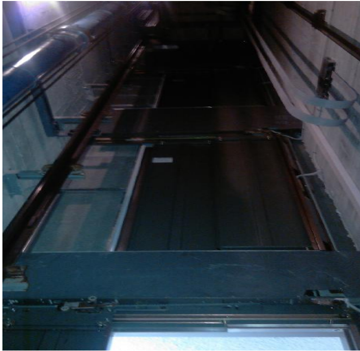
Εικόνα 4.3.: Εσωτερική άποψη αυτόματων θυρών υδραυλικού ανελκυστήρα.
