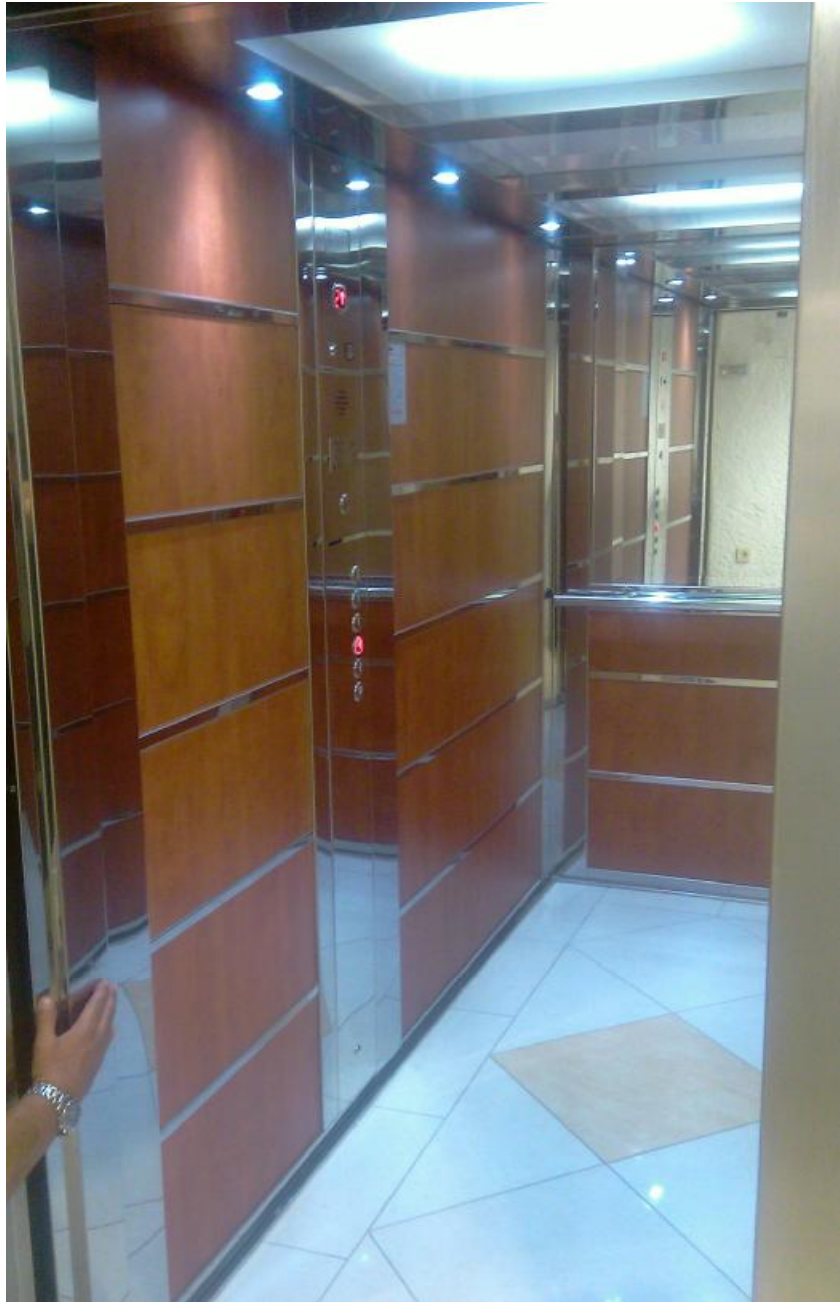
Εικόνα 4.9.: Εσωτερική άποψη θαλάμου υδραυλικού ανελκυστήρα.
