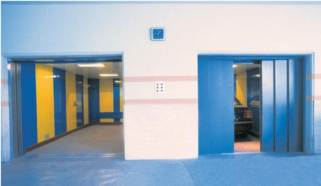
Εικόνα 1.4.: Υδραυλικός ανελκυστήρας σε χώρο στάθμευσης αυτοκινήτων.
