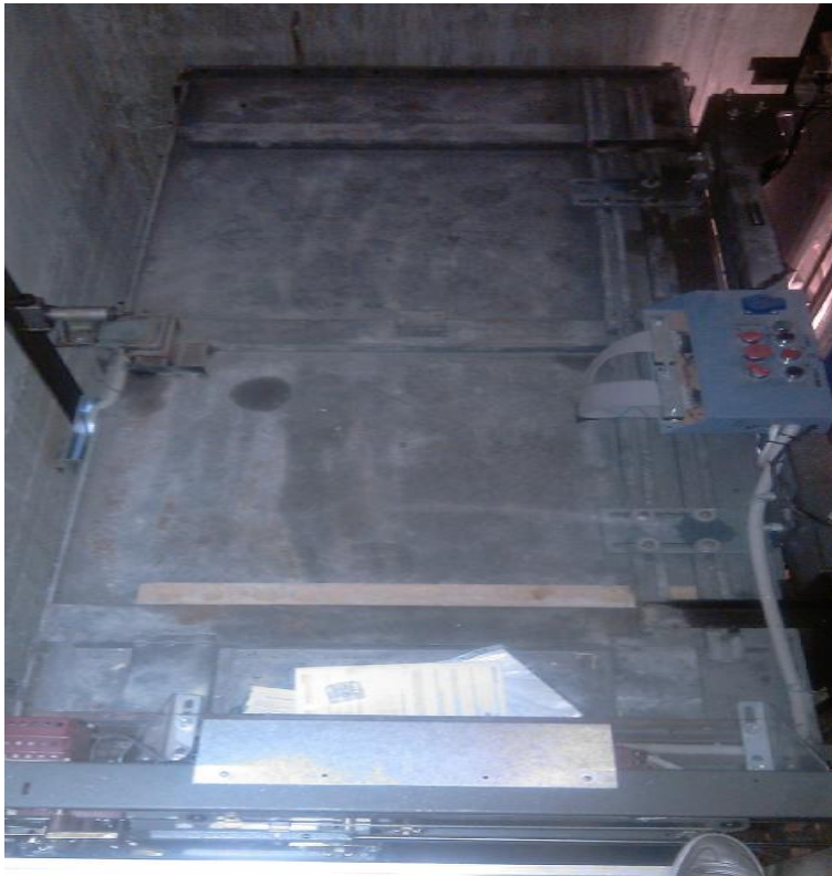
Εικόνα 4.4.: Άνωθεν μέρος θαλάμου και πίνακας συντήρησης υδραυλικού ανελκυστήρα.
