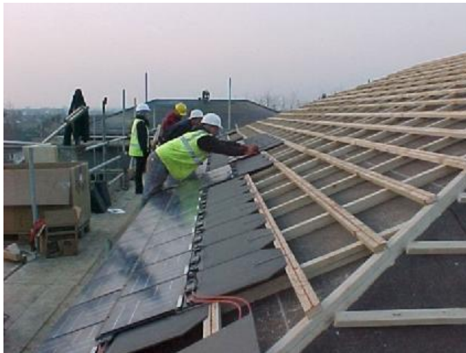
Εικόνα 6.5: Εγκατάσταση ενσωματωμένη σε οροφή
