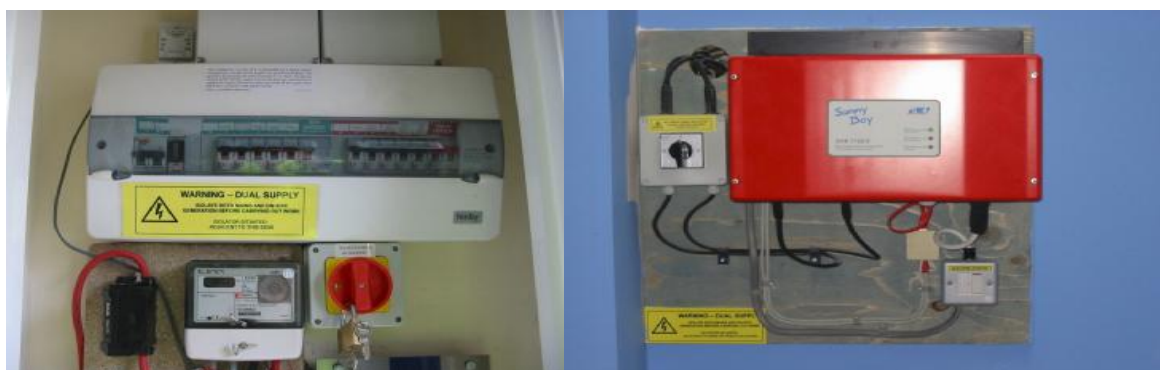
Εικόνα 6.7: Αναγραφή προειδοποιητικών σημάνσεων σε πίνακα και inverter
