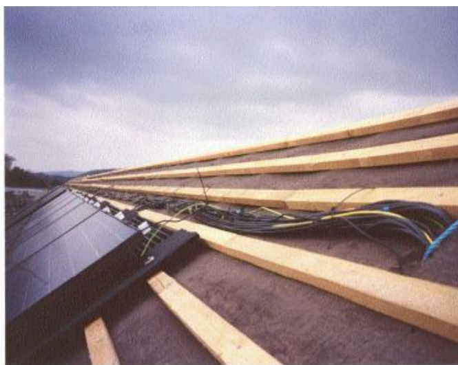
Εικόνα 6.6 : Καλωδιώσεις Φ/Β εγκατάστασης σε στέγη
