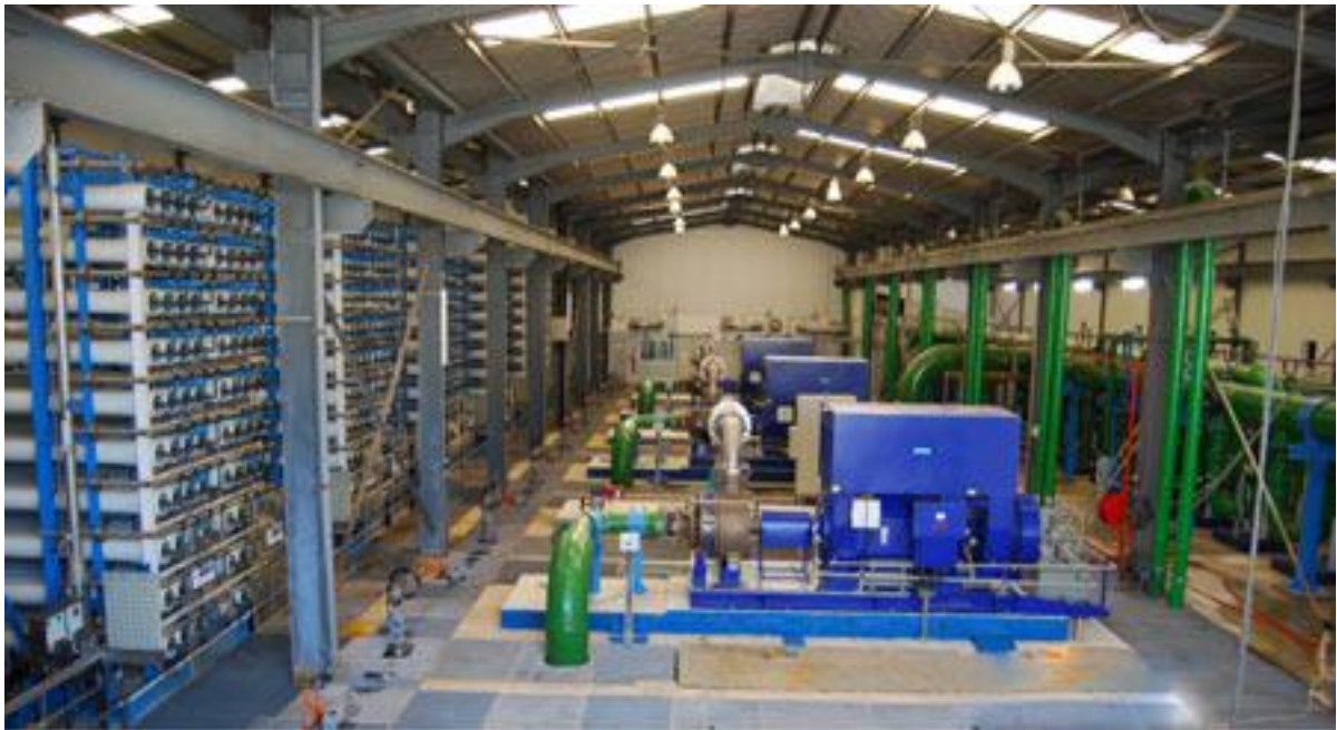
Σχήμα 4.5: Αντλίες υψηλής πίεσης, Πηγή : Τμήμα αναπτύξεως Υδάτων.
