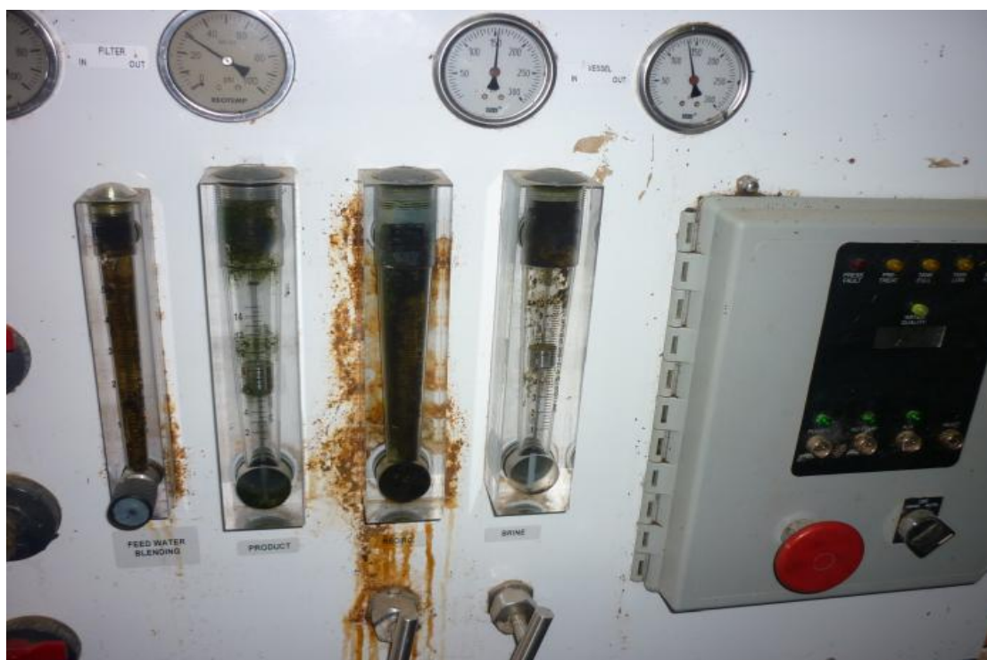
Σχήμα 7.1: Πίνακας ελέγχου υφιστάμενης εγκατάστασης. Πηγή : φωτογραφήθηκε από εμάς στην κτηνοτροφική μονάδα.
