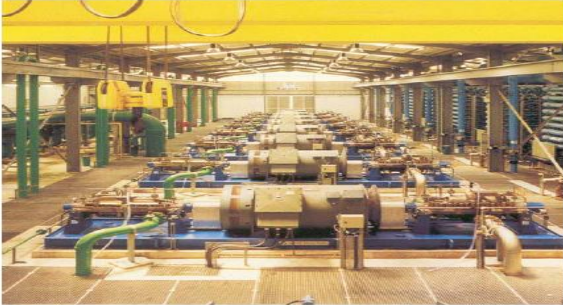
Σχήμα 4.4: Αντλίες υψηλής πίεσης. Πηγή : Τμήμα Αναπτύξεως υδάτων.
