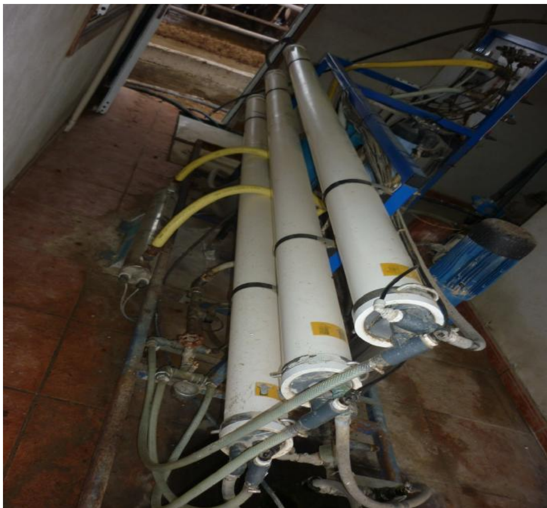
Σχήμα 7.2: Εικόνα υφιστάμενης μονάδας αφαλάτωσης. Πηγή : φωτογραφήθηκε από εμάς στην κτηνοτροφική μονάδα.
