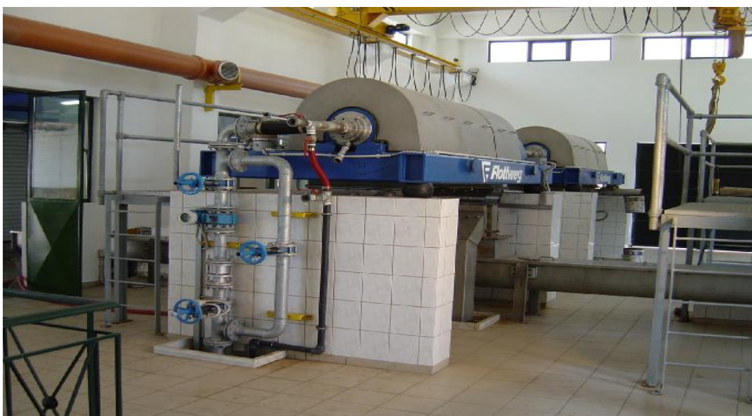
Εικόνα 33 : Μονάδα μηχανικής πάχυνσης της ιλύος
