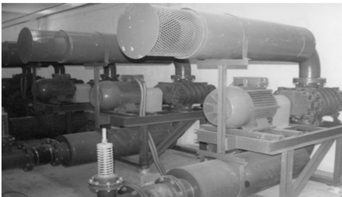
Εικόνα 6. Αεριστήρες περιστρεφόμενων λαβών για την τροφοδοσία αέρα
