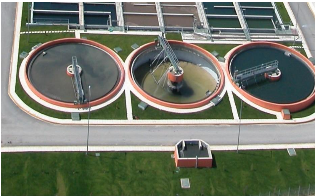
Εικόνα 29 : Δεξαμενές Πρωτοβάθμιας καθίζησης
