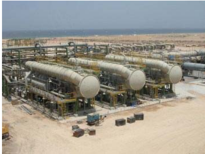
Εικόνα 3.1 Εγκατάσταση πολυβάθμιας εξάτμισης στο Ομάν.
