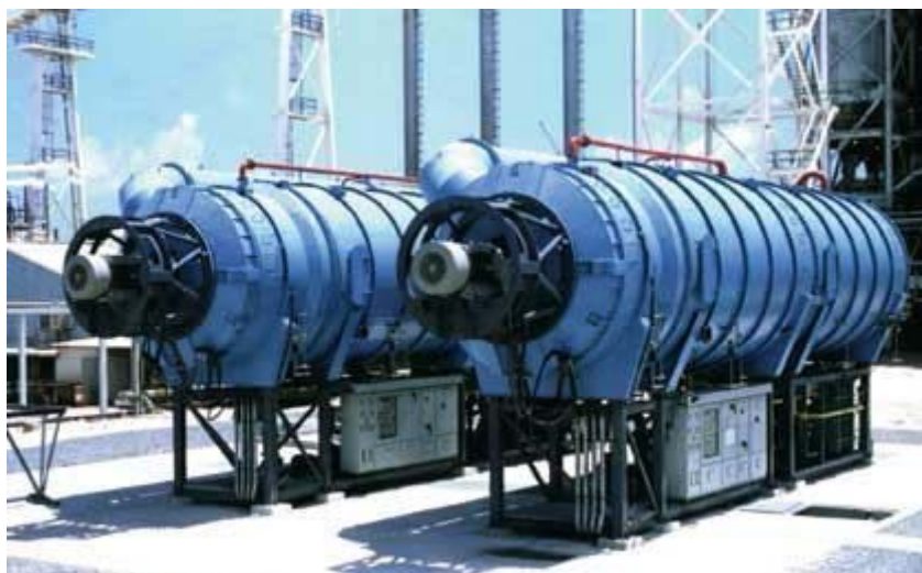
Εικόνα 3.3 Μονάδα αφαλάτωσης με συμπίεση ατμού στη Σαρδηνία.
