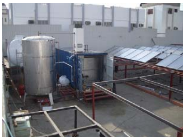
Εικόνα 5.1 Μονάδα ύγρανσης-αφύγρανσης δυναμικότητας 5\text{m}^3/\text{ημέρα} στην Τζέντα της Σαουδικής Αραβίας που χρησιμοποιεί επίπεδους ηλιακούς συλλέκτες συνολικού εμβαδού 140\text{ m}^2 .
