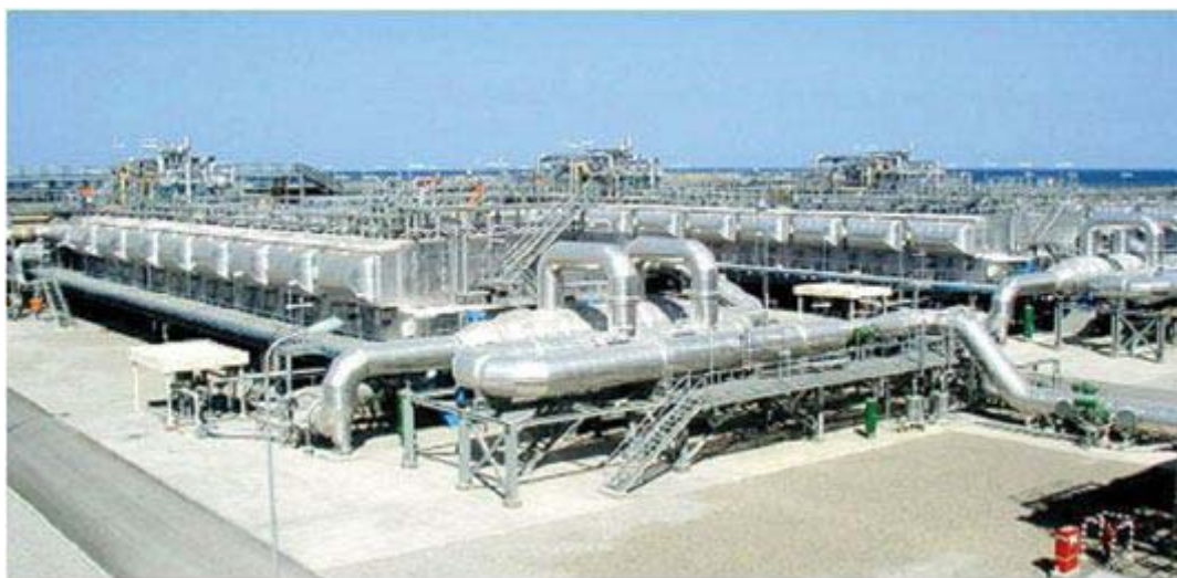
Εικόνα 3.2 Εγκατάσταση πολυβάθμιας εκτόνωσης στη Μέση Ανατολή.
