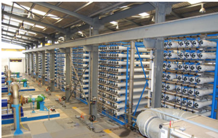
Εικόνα 4.2 Μονάδες αντίστροφης όσμωσης στην εγκατάσταση αφαλάτωσης στην Δεκέλεια της Κύπρου.
