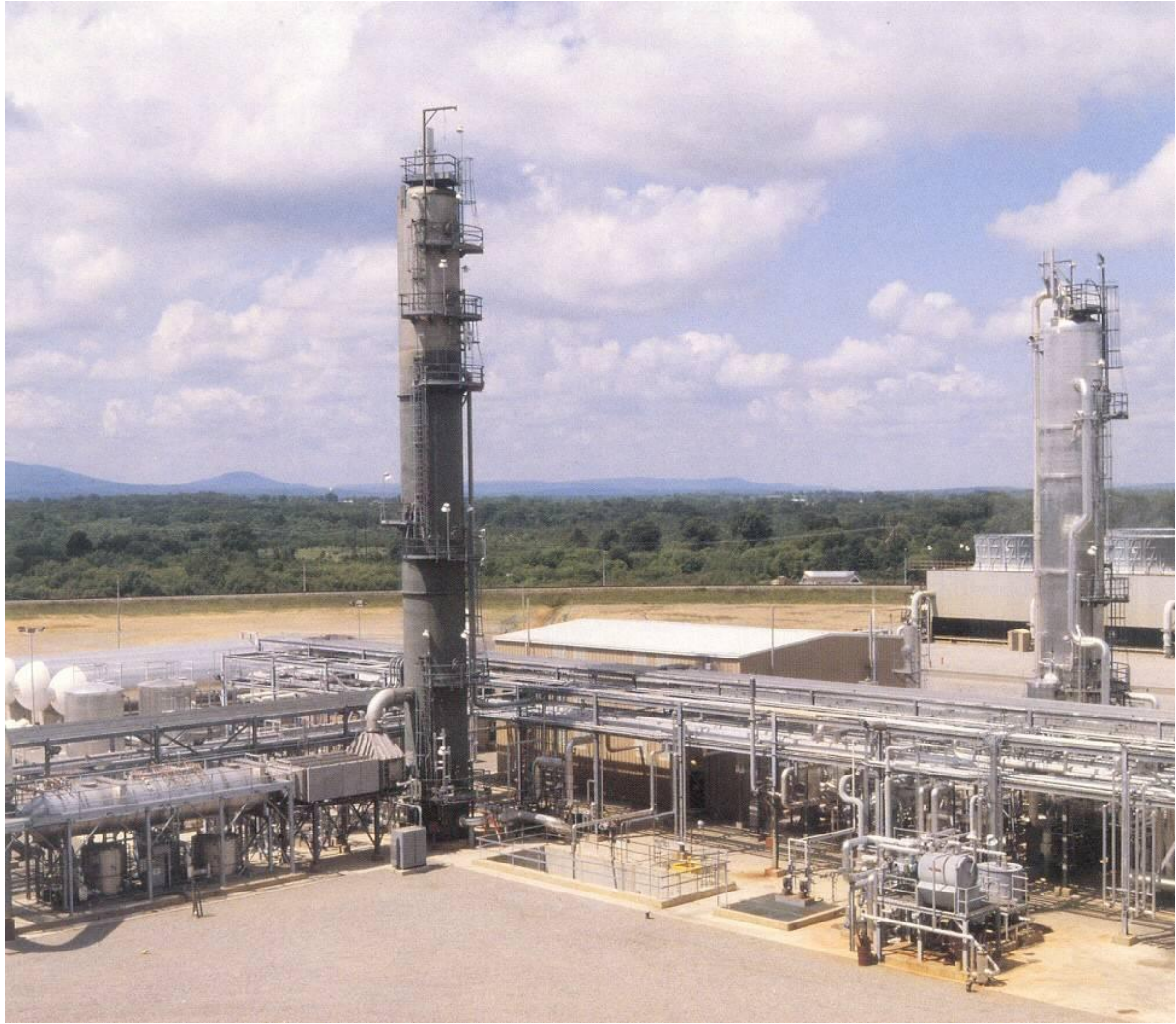
Εικόνα 2.1 Μονάδα δέσμευσης μετά την καύση
