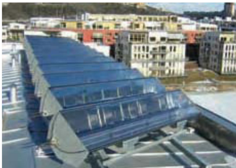
Εικόνα 2.4: Συγκεντρωτικό φβ/θ σύστημα
