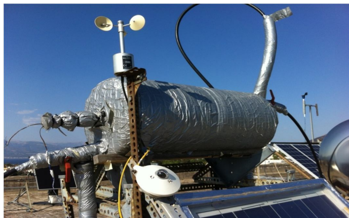
Εικόνα 3.3: Θερμικά μονωμένο κυλινδρικό δοχείο αποθήκευσης νερού
