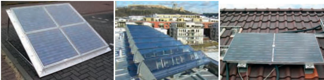
Εικόνα 2.3: Πρακτικά παραδείγματα φβ/θ συστημάτων νερού.
