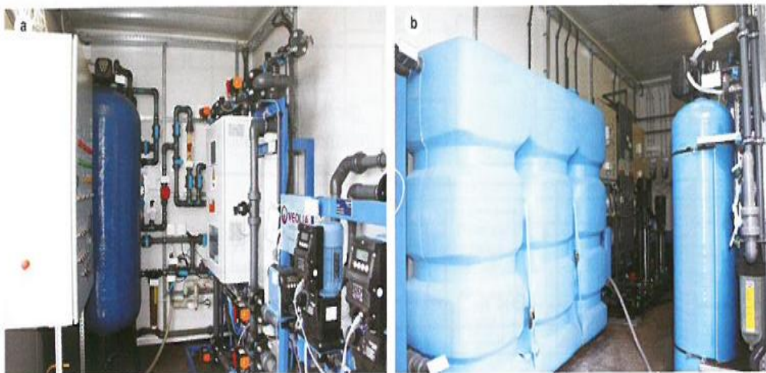
Εικόνα 3.12: Εγκατάσταση γεωθερμίας αφαλάτωσης νερού: α) προεπεξεργασία νερού (μηχανικό φίλτρο, στάδιο αφαίρεσης σιδήρου και στοιχείο υπερδιήθησης, β) ενδιάμεση δεξαμενή πριν το στοιχείο RO και τελική επεξεργασία (ορυκτοποίηση).
