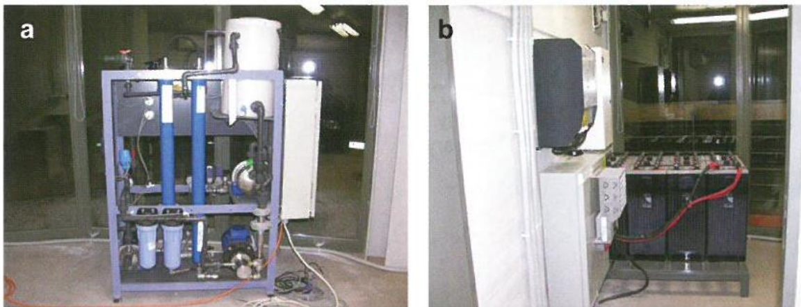
Εικόνα 2.11: Μονάδα RO υβριδική στο ΚΑΠΕ, α) μονάδα 130L/h θαλασσινού νερού, β) σύστημα αποθήκευσης συσσωρευτή, μετατροπείς
