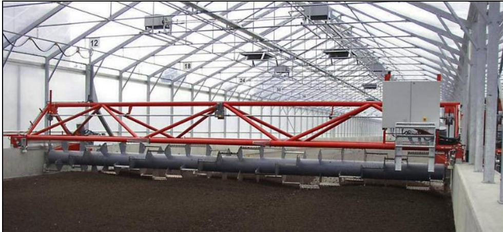
Σχήμα 3.6: Ηλιακό ξηραντήριο θερμοκηπίου με ανεμιστήρες.
