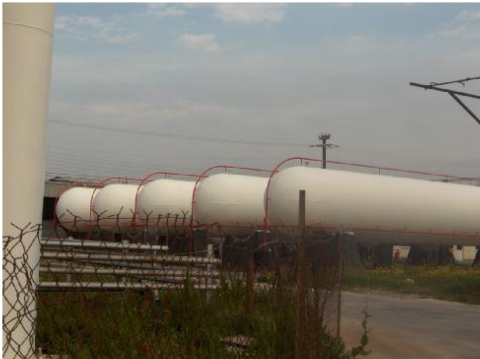
Εικόνα 25: Υπέργειες δεξαμενές αποθήκευσης υγραερίου
