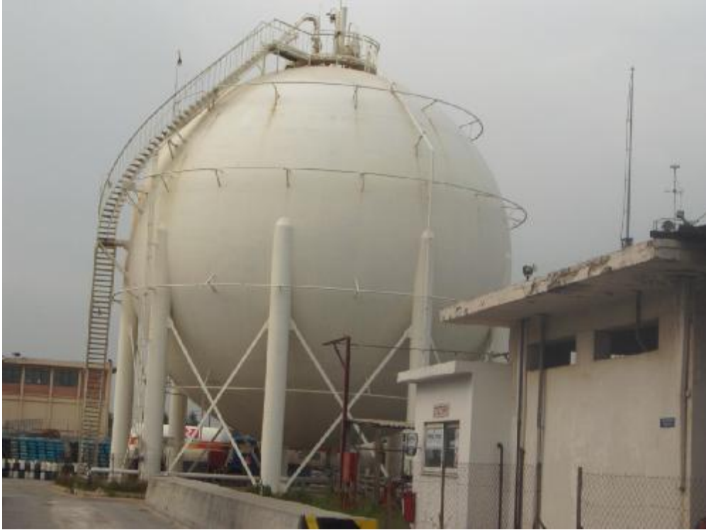
Εικόνα 24: Κυκλική δεξαμενή αποθήκευσης υγραερίου
