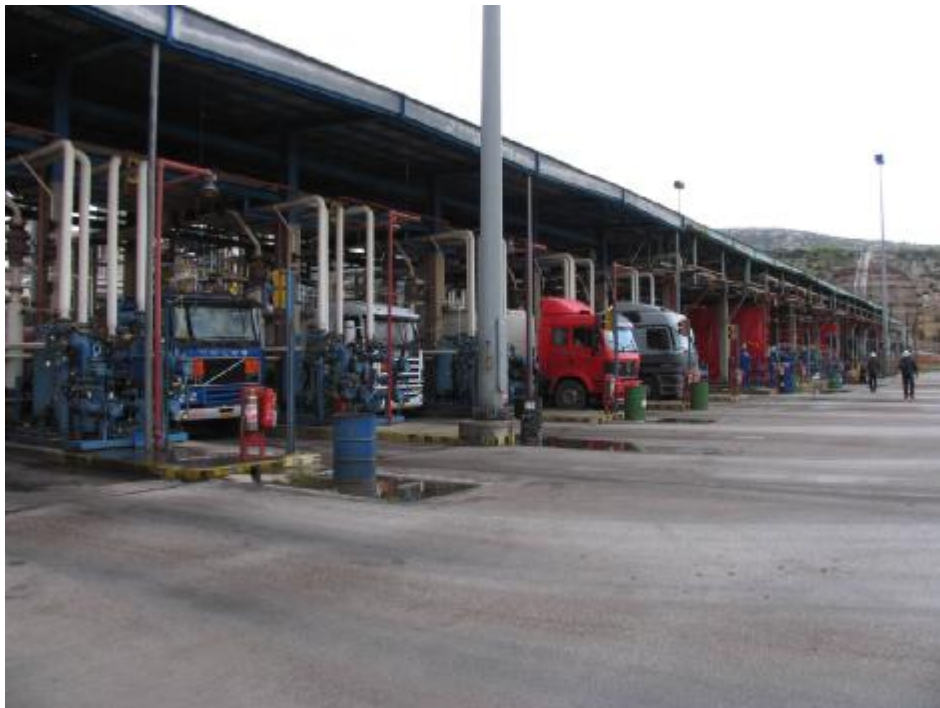
Εικόνα 29: Σταθμός φόρτωσης βυτιοφόρων οχημάτων
