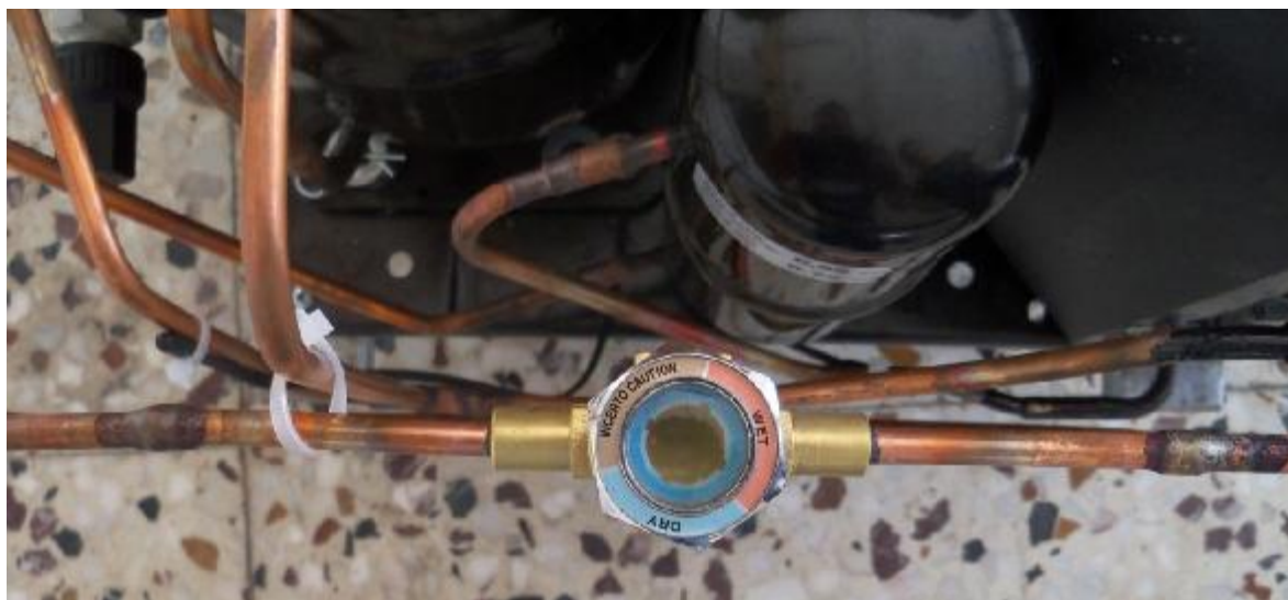
Εικόνα 2.11: Δείκτης ροής, για να βλέπουμε την ροή του ψυκτικού μέσου μέσα στο κύκλωμα, και να παρατηρούμε την ατμοποίηση του ψυκτικού μέσου όταν αυτό είναι σε λειτουργία, είναι τοποθετημένο πριν το συμπυκνωτή.
