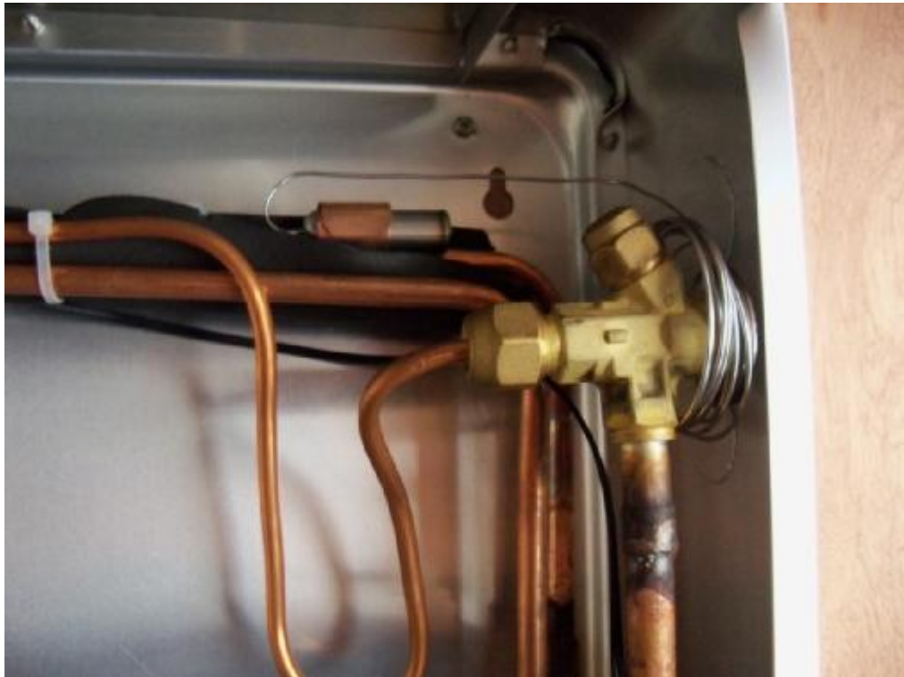
Εικόνα 2.6: Βαλβίδα R134 DANFOSS κολλητή, η οποία είναι η εκτονωτική διάταξη του συστήματος.
