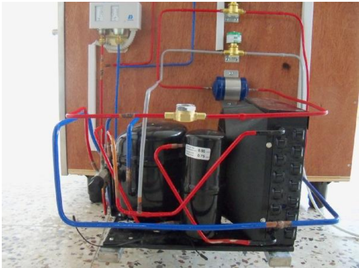
Εικόνα 2.17: Στην εικόνα φαίνεται η παράκαμψη με το γκρι σωλήνα ο οποίος παρακάμπτει τον εξατμιστή και διοχετεύει τον συμπυκνωτή με ψυκτικό μέσο κατάστασης υπέρθερμου ατμού.
