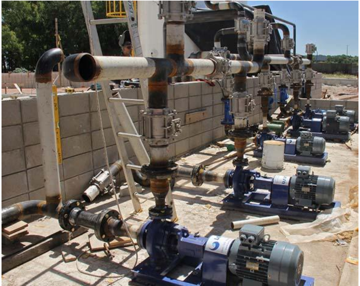
Εικόνα 39: Αντλιοστάσιο μονάδας. (www.biofuels.gr).
