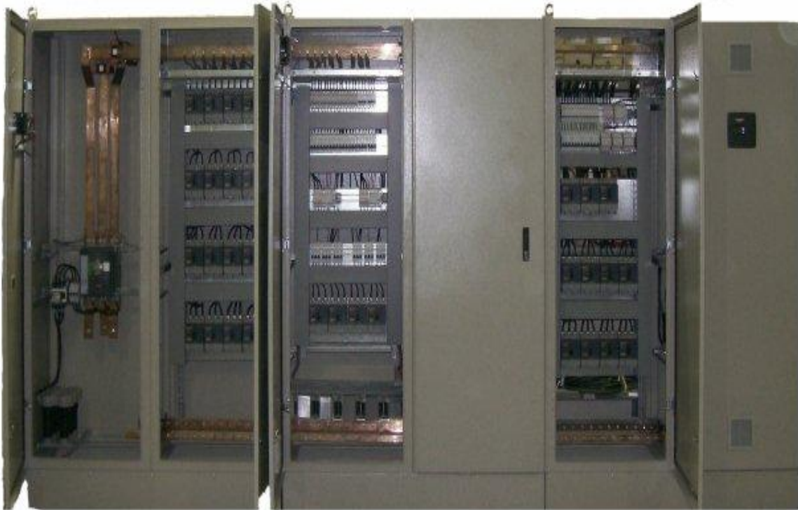
Εικόνα 3.14 Ηλεκτρικός πίνακας σε υδροηλεκτρικό σταθμό
