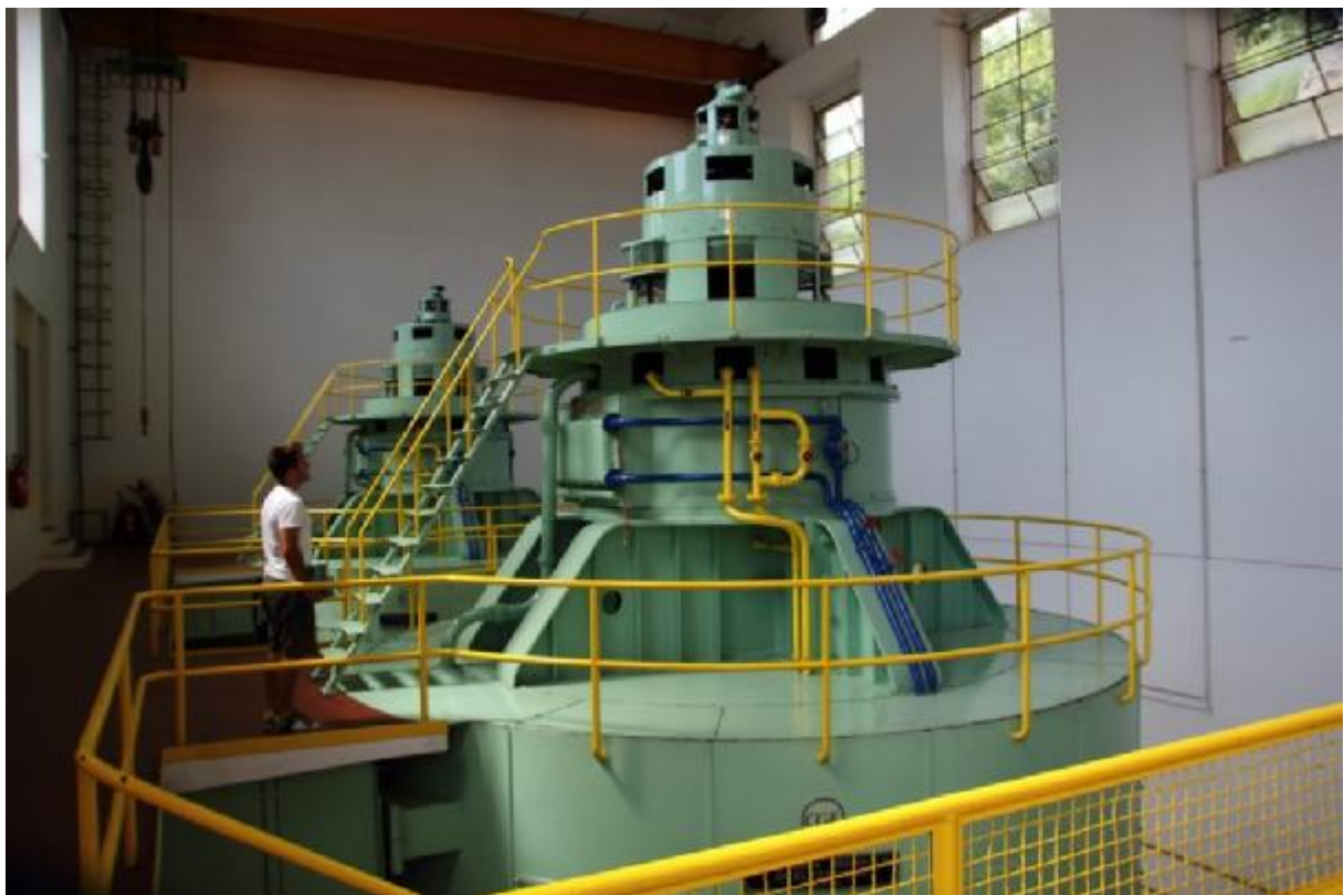
Εικόνα 3.11 Γεννήτρια σε υδροηλεκτρικό σταθμό
