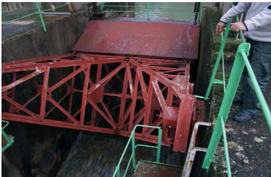
Εικόνα 2.10 Ηλεκτρικό τοξωτό θυρόφραγμα
